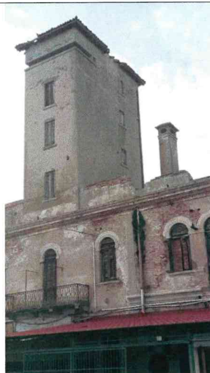
Foto 2 – pericolo caduta coppi
