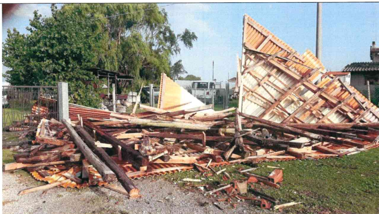
Foto 2 – copertura spazzata via dal vento
