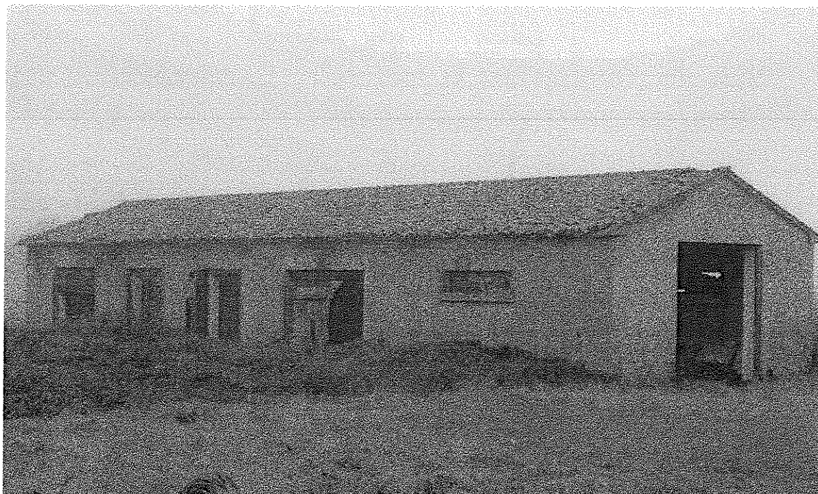
Foto 05 vista fabbricato secondario dove occorre rimuovere i rifiuti di vario genere presenti e chiudere le aperture con rete elettrosaldata e tubi innocenti e rete arancione plastificata
