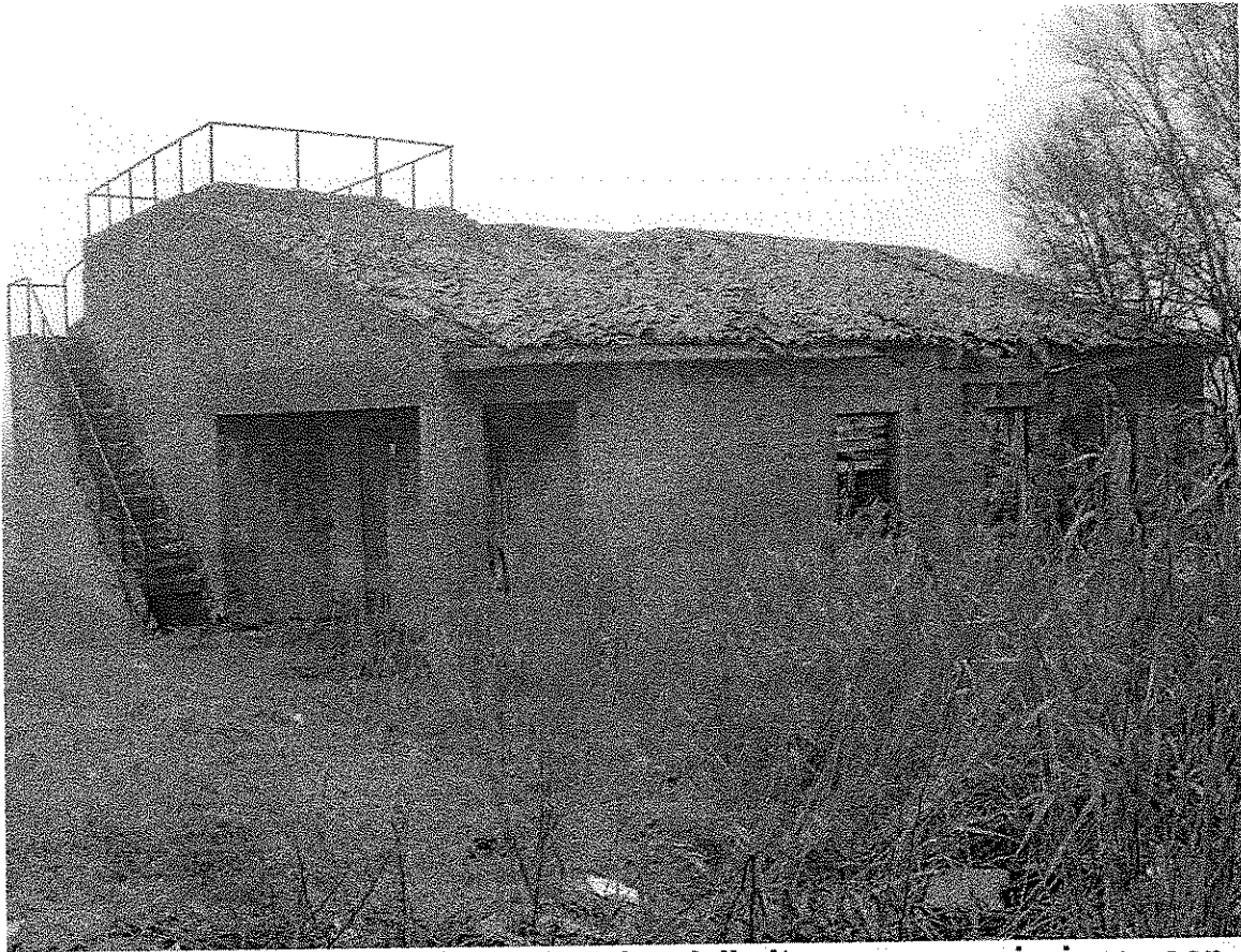
Foto 03 vista fabbricato principale da delimitare con recinzione con rete elettrosaldata e tubi innocenti e rete arancione plastificata.
