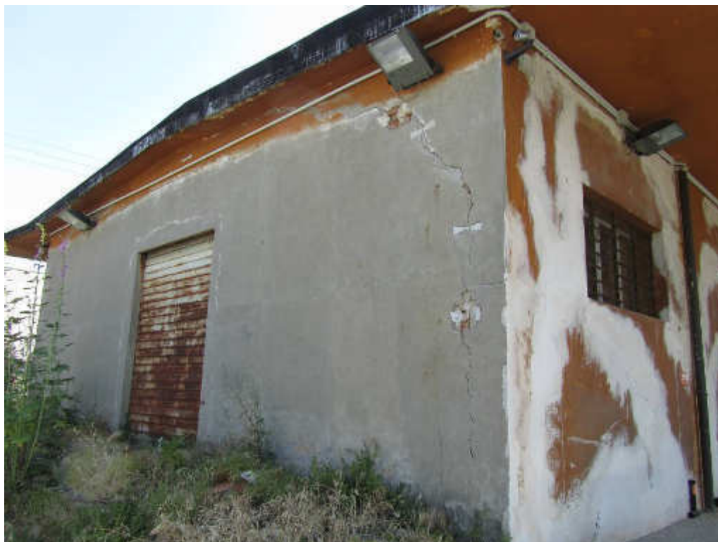
Foto n. 1: ripresa delle lesioni presenti all'estremità NO del fabbricato esistente
