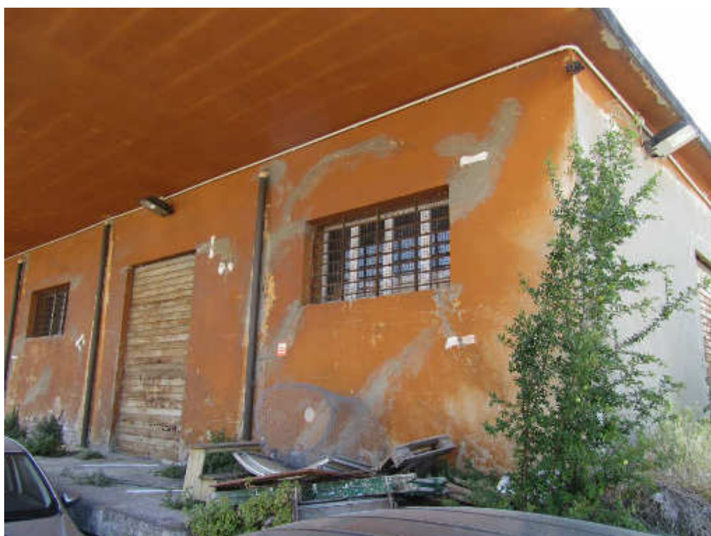
Foto n. 2: ripresa delle lesioni presenti all'estremità NO del fabbricato esistente
