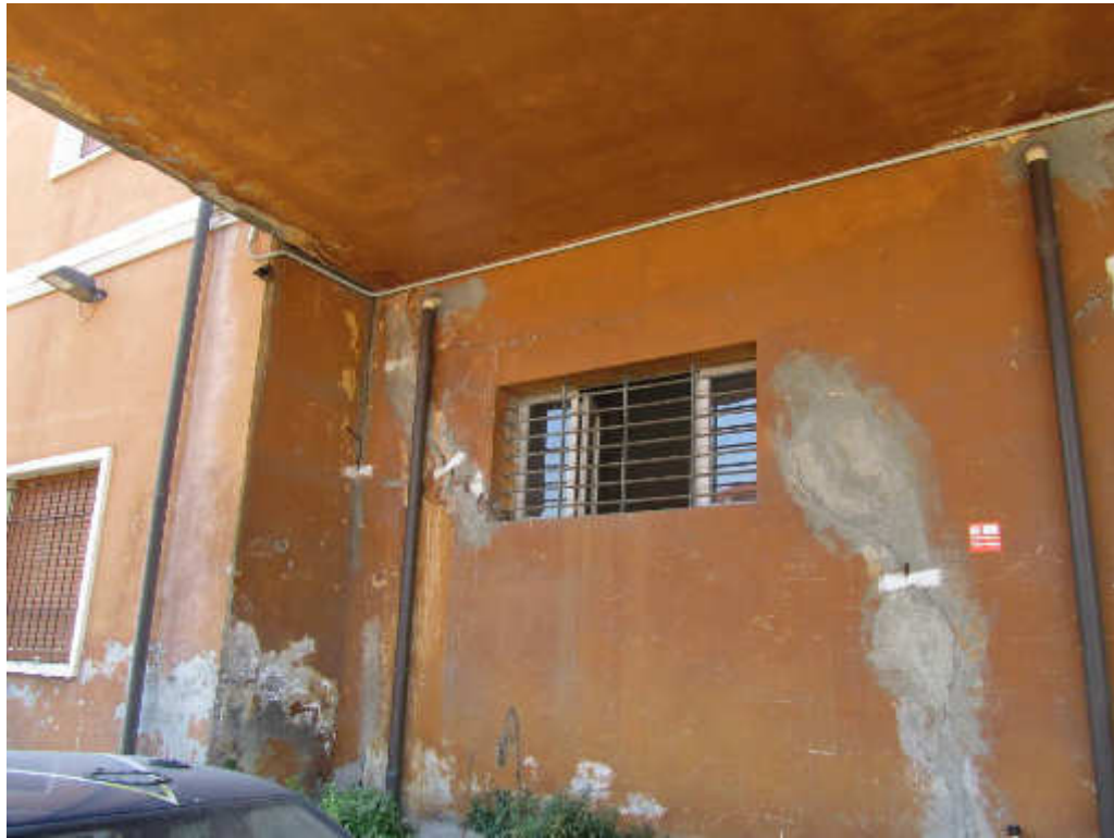
Foto n. 31: ripresa delle lesioni presenti all'estremità SE del fabbricato esistente
