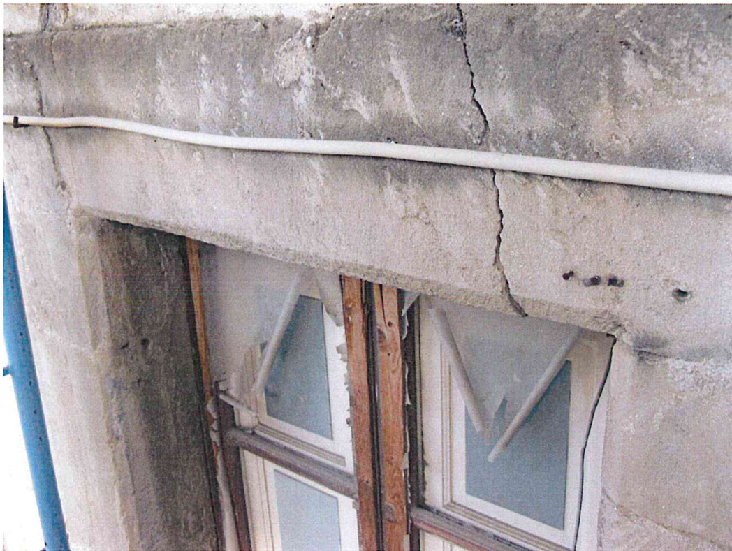
Elementi lesionati da puntellare prospetto sud cortile Palazzo Marchesi
