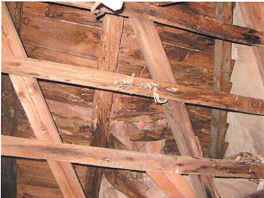
Travi della copertura in fase di crollo
