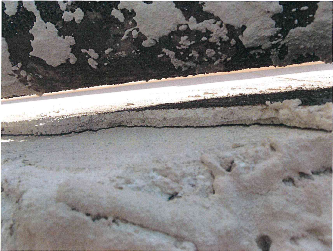
Intonaco in fase di distacco prospetto est su strada pubblica
