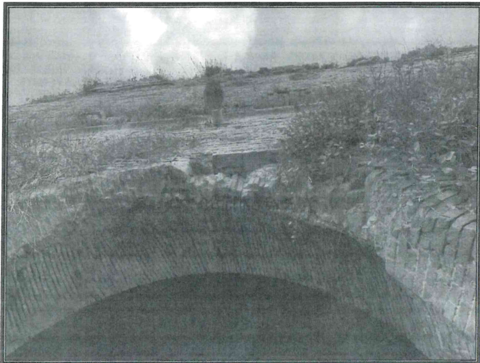
Foto 2. Particolare arco murario con forti segni di deterioramento e assenza di elementi portanti originari, andando a compromettere anche la forma originaria dello stesso.
