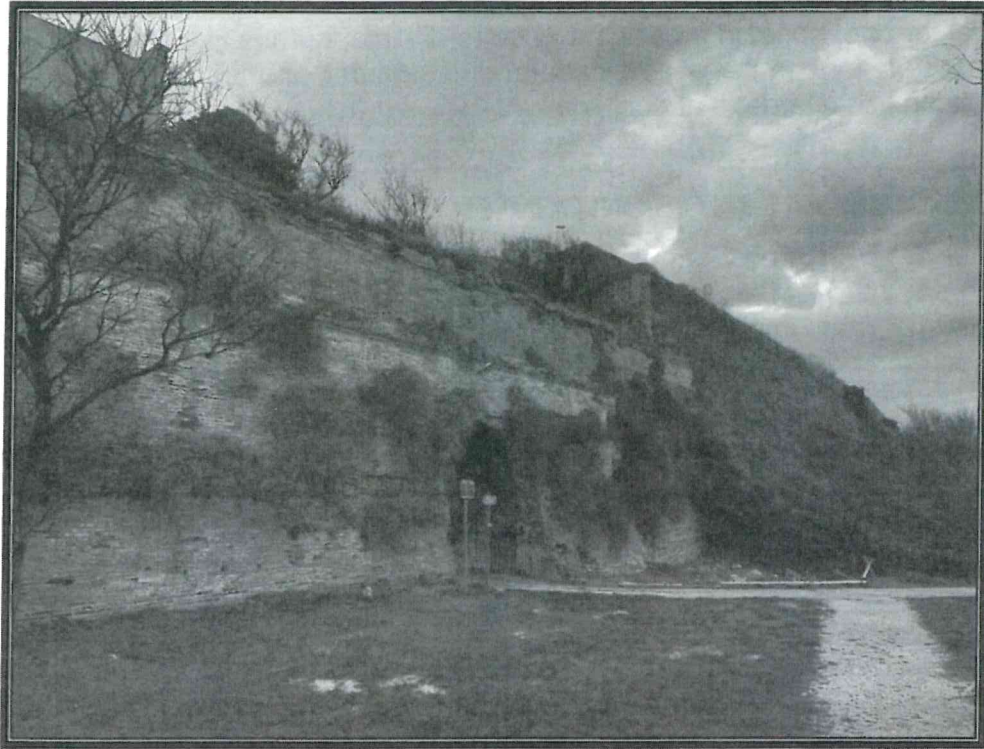
Foto 1. Vista Arco e cinta muraria "Parco del Cardeto", dove è visibile molta vegetazione che danneggia la muratura portante
