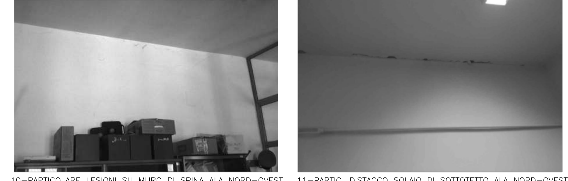
10-PARTICOLARE LESIONI SU MURO DI SPINA ALA NORD-OVEST 11-PARTIC. DISTACCO SOLAIO DI SOTTOTETTO ALA NORD-OVEST
