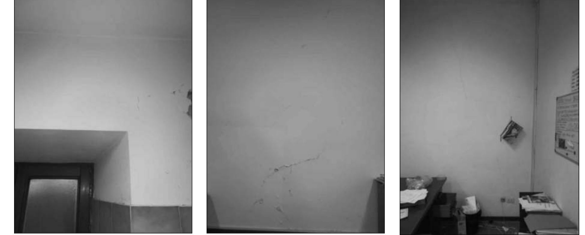
12-PARTICOLARE LESIONE MURO PERIMETRALE ALA NORD-EST 13-PARTIC. LESIONE MURO DI SPINA ALA NORD-EST 14-PARTIC. LESIONE MURO PERIMETRALE ALA NORD-OVEST
