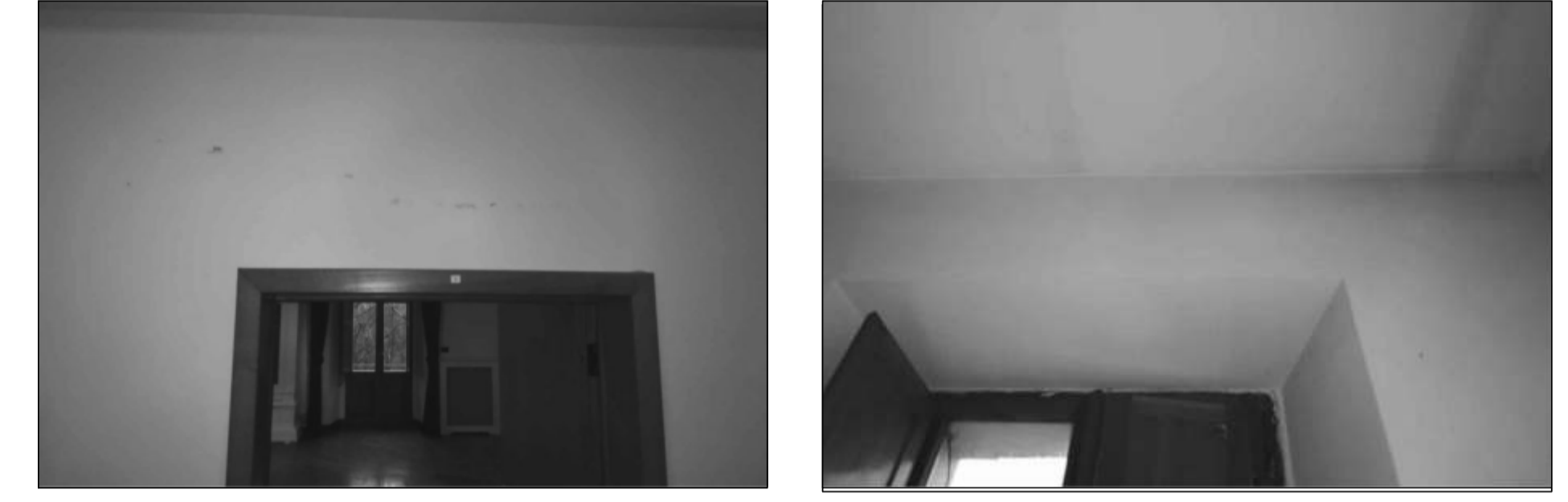
4-PARTICOLARE LESIONI MURO DI SPINA ALA NORD-EST 5-PARTICOLARE LESIONE ARCHITRAVE ALA NORD-EST
