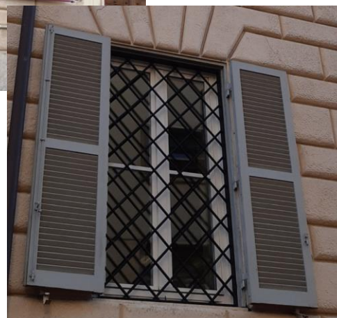
Prospetto A e B, sostituzione inferriata a protezione degli infissi del P.T. del teatro dei Dioscuri con l'intento di uniformare il linguaggio architettonico della facciata. Scelta stilistica dell'inferriata ad OCCHIO ABBOTTATO
