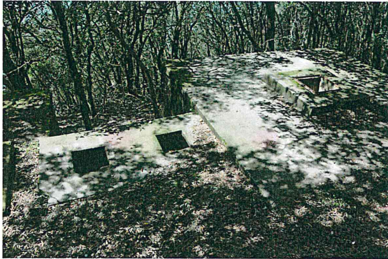
Foto raffigurante gli accessi delle cisterne prive dei chiusini
