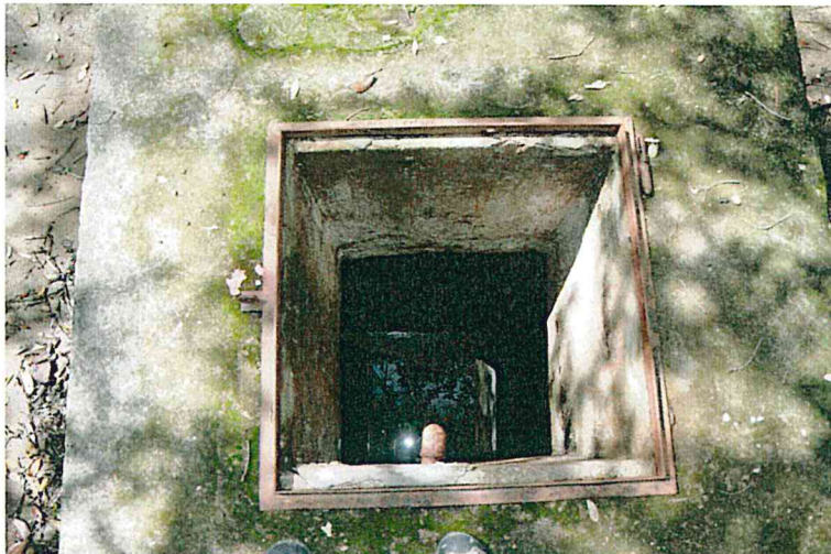
Foto raffigurante l'accesso della cisterna priva del chiusino
