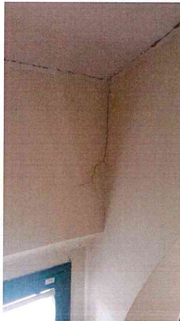
Punto di infiltrazione n.1)
