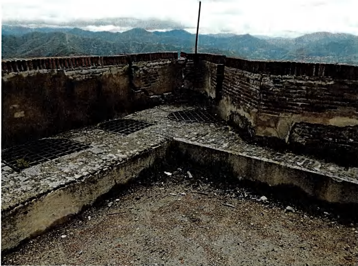
Fig. 9 parapetti instabili della torre-caserma lato Nord-Est
