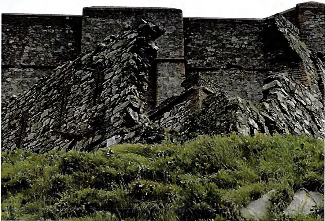
Fig. 2 Breccia sulla cinta muraria esterna lato Ssud – vista dall'esterno
