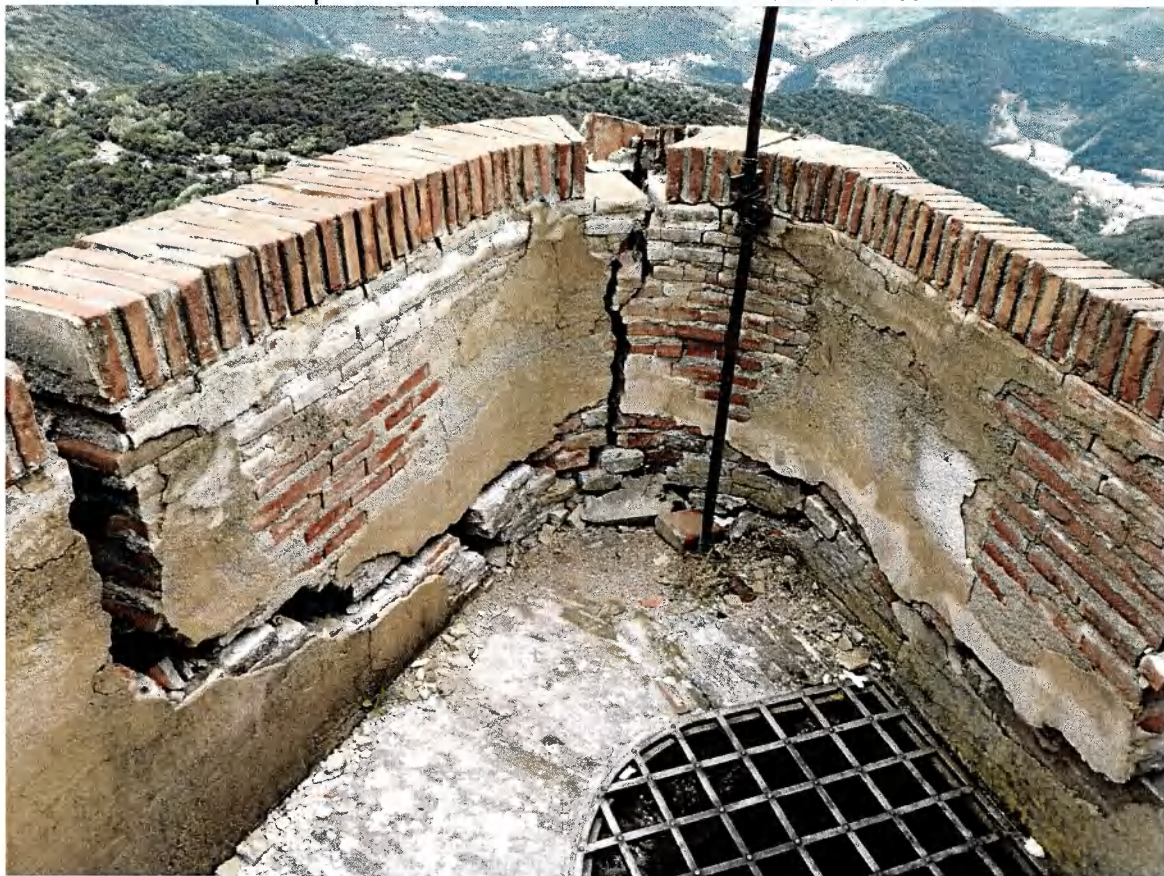
Fig. 10 parapetti instabili della torre-caserma lato Nord-Est
