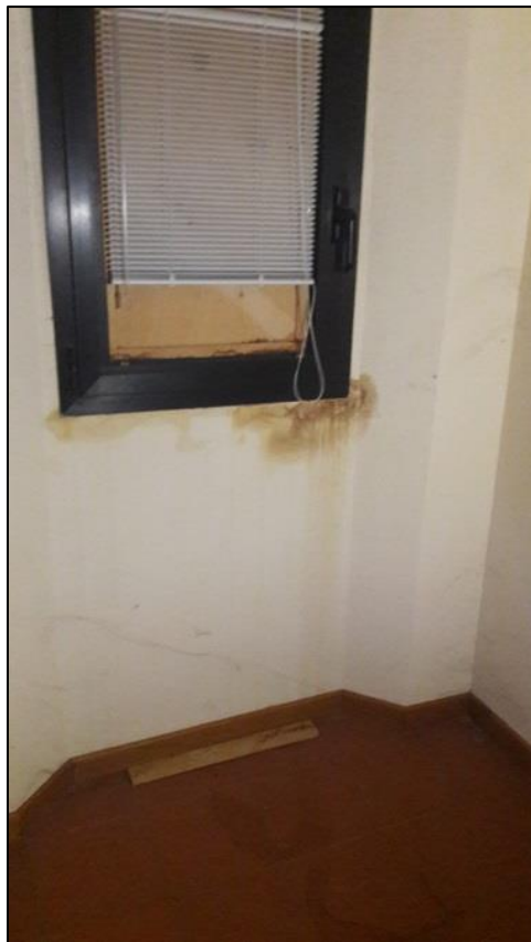
Punto di infiltrazione n.4)
