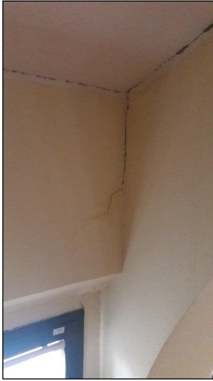
Punto di infiltrazione n.1)
