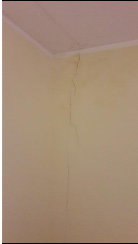
Punto di infiltrazione n.3)
