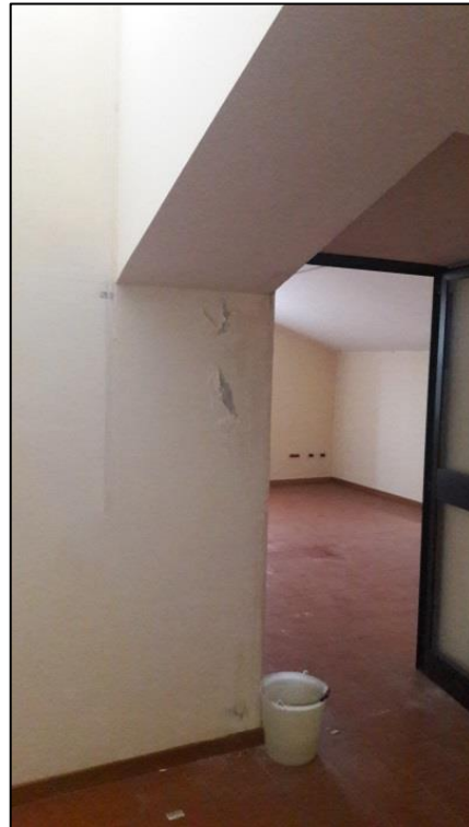
Punto di infiltrazione n.2)
