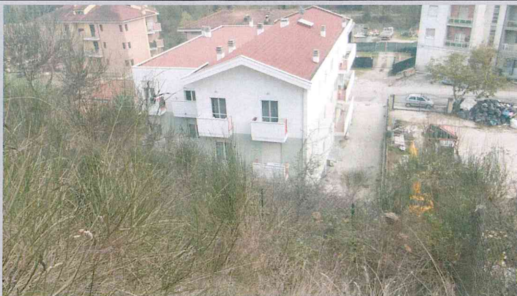
FOTO 04 – Vista del fabbricato in prossimità del ciglio della scarpata
