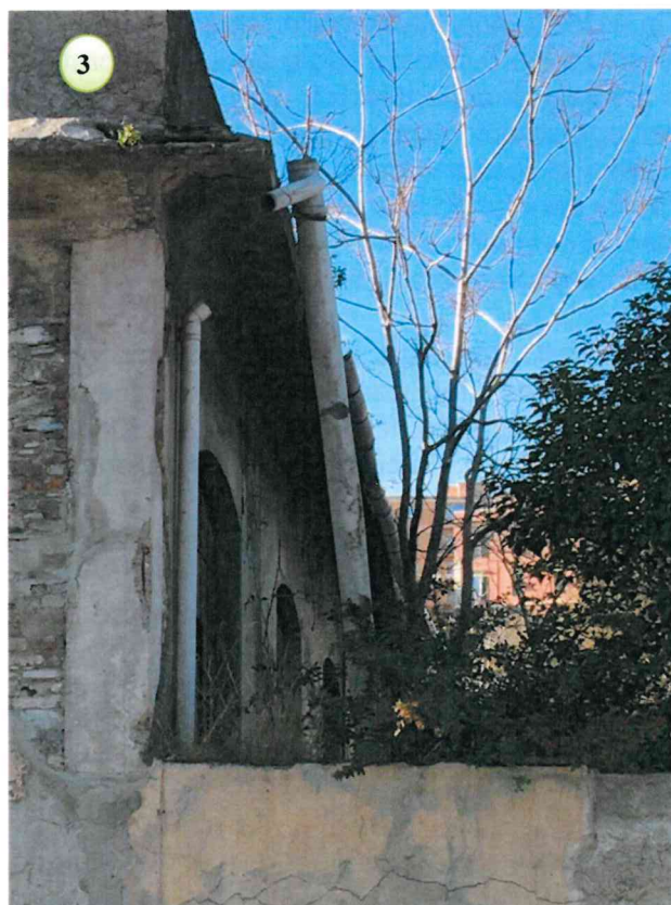
Fig. 12 – Distacco porzione di gronda del corpo basso a Sud (fabbricato “3” in fig. 1) segnalato il 29/01/2019 dalla Miceli Amministrazione S.r.l. (vista da Est)
