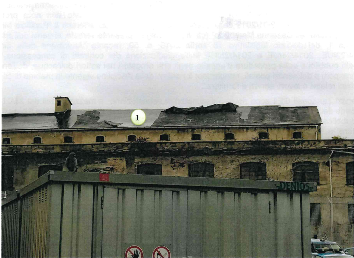
Fig. 2 – Distacco guaina bituminosa in copertura “Panificio Militare” (fabbricato “1” in fig. 1) segnalato il 23/01/2019 dalla Polizia Municipale di Genova, settore Ambiente (vista da Sud)
