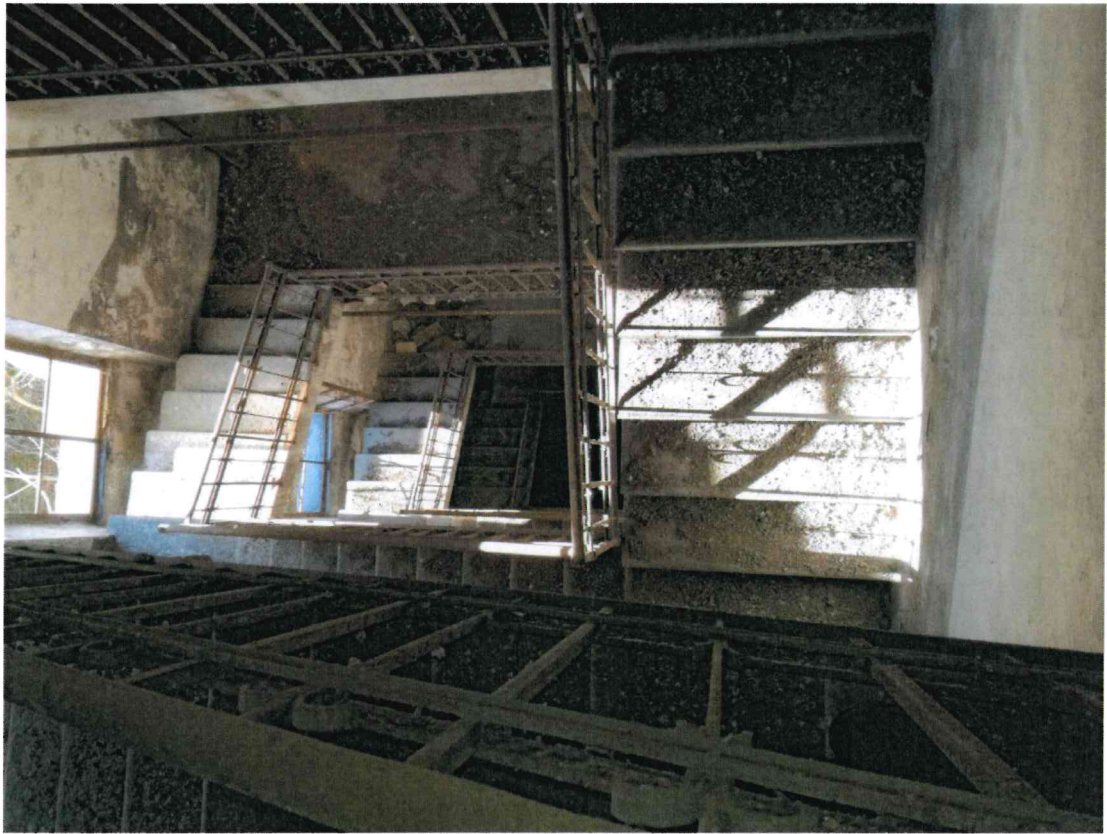
Fig. 9 – Scala a Ovest di accesso al locale tecnico in copertura del fabbricato "1"
