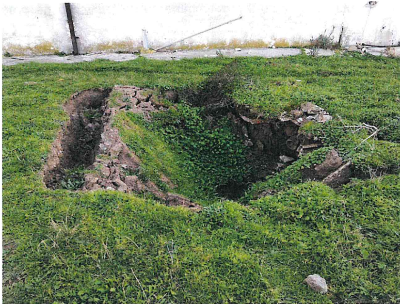
Cedimento del terreno nel retro della Palazzina Direttore
