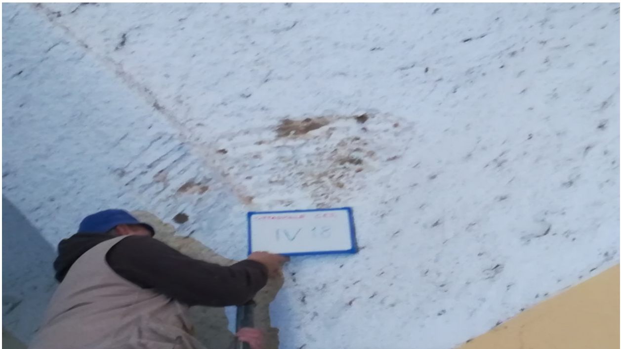
Foto n.28- INDAGINE VISIVA IV 18
