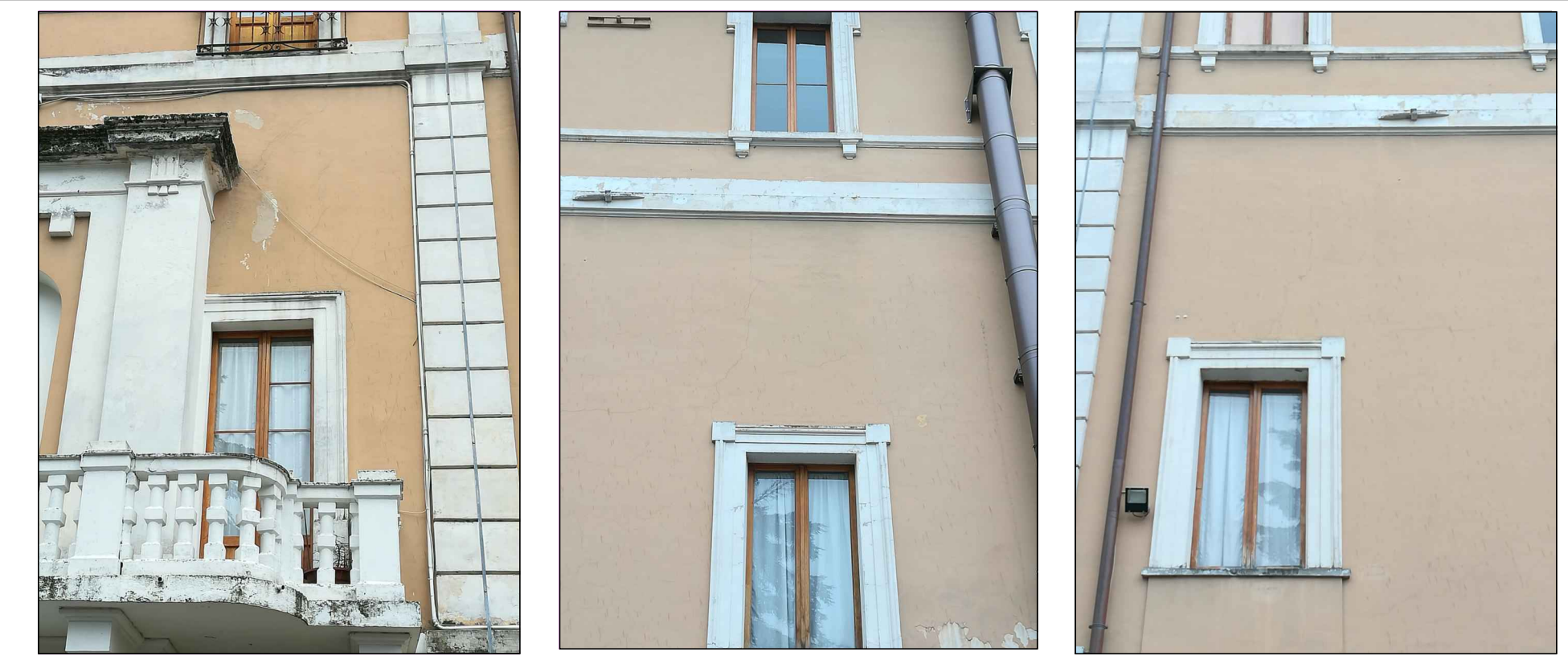
1-PARTICOLARE LESIONI ALA NORD-EST 2-PARTICOLARE LESIONI ALA NORD-EST 3-PARTICOLARE LESIONI ALA NORD-EST
