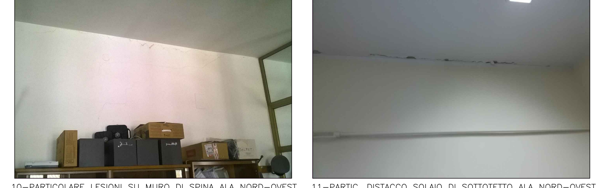
10-PARTICOLARE LESIONI SU MURO DI SPINA ALA NORD-OVEST 11-PARTIC. DISTACCO SOLAIO DI SOTTOTETTO ALA NORD-OVEST
