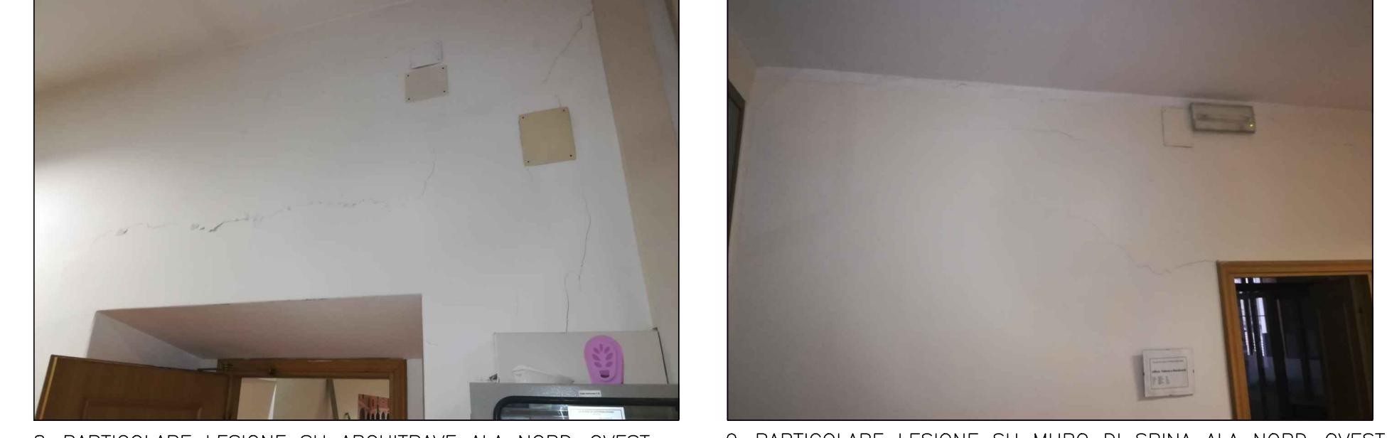
8-PARTICOLARE LESIONE SU ARCHITRAVE ALA NORD-OVEST 9-PARTICOLARE LESIONE SU MURO DI SPINA ALA NORD-OVEST
