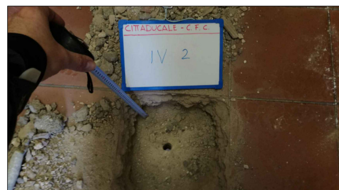
Foto n.3 - INDAGINE VISIVA IV 2
