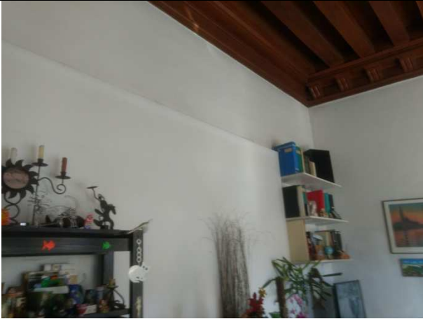
Foto 03 – salone centrale (tramezzo)
