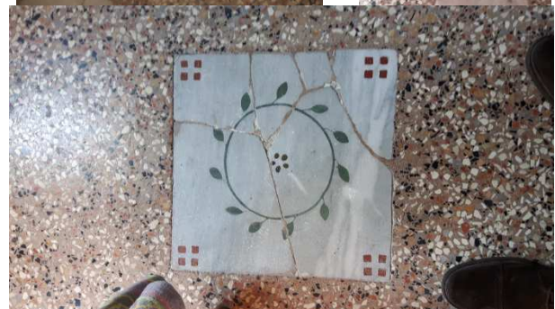
Dettagli di mosaico a pavimento e inseriti in marmo su terrazzo alla veneziana al piano primo, interventi recenti hanno compromesso la lettura nella sua interezza in quanto vi insiste una tramezza in cartongesso
