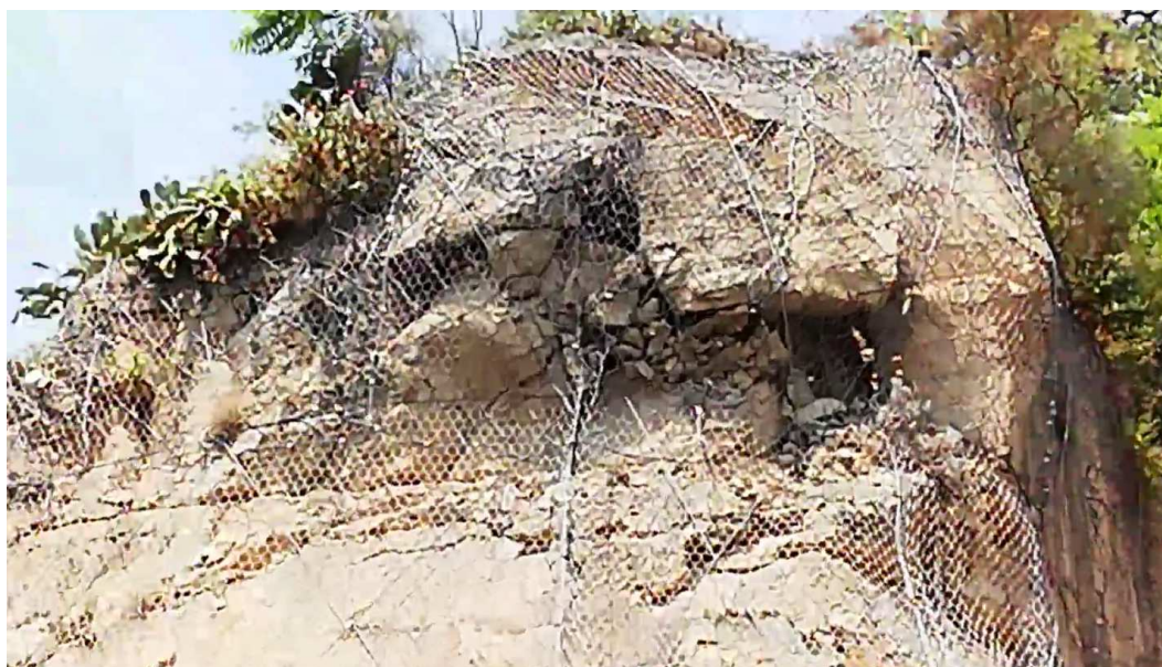
Foto 1 – Blocco tufaceo frammentato e svincolato dalla parete
