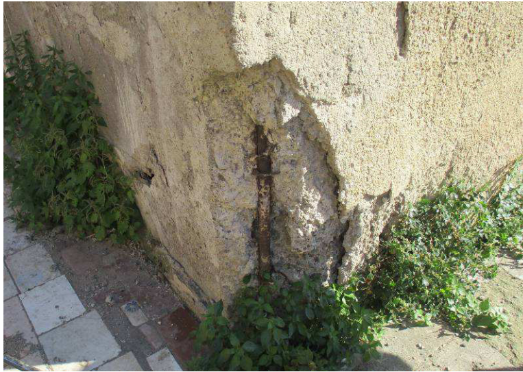
Figura 31 Particolare barra longitudinale \phi 20 liscia visibile sul pilastro d'angolo.
