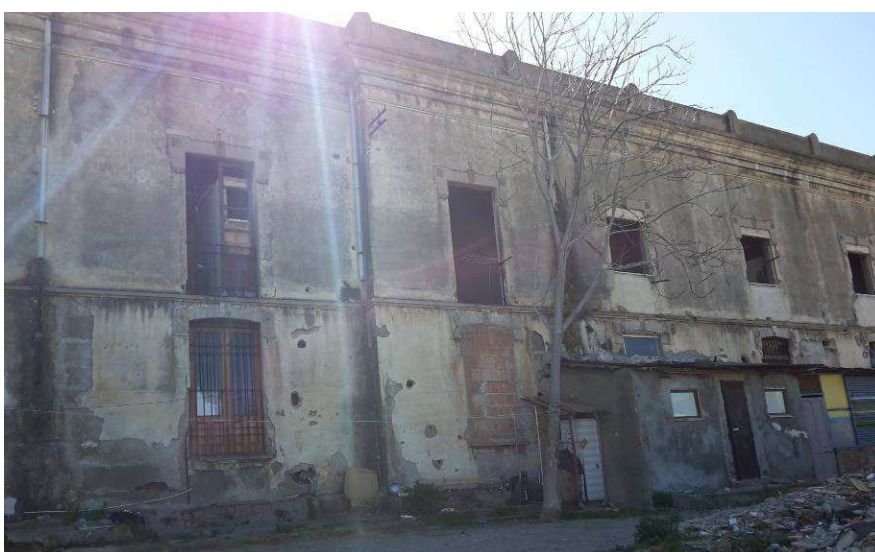
Foto 2 Vista della facciata nord-ovest del Blocco A: sono visibili le condizioni di ammaloramento delle pareti esterne sia a piano terra che a primo piano
