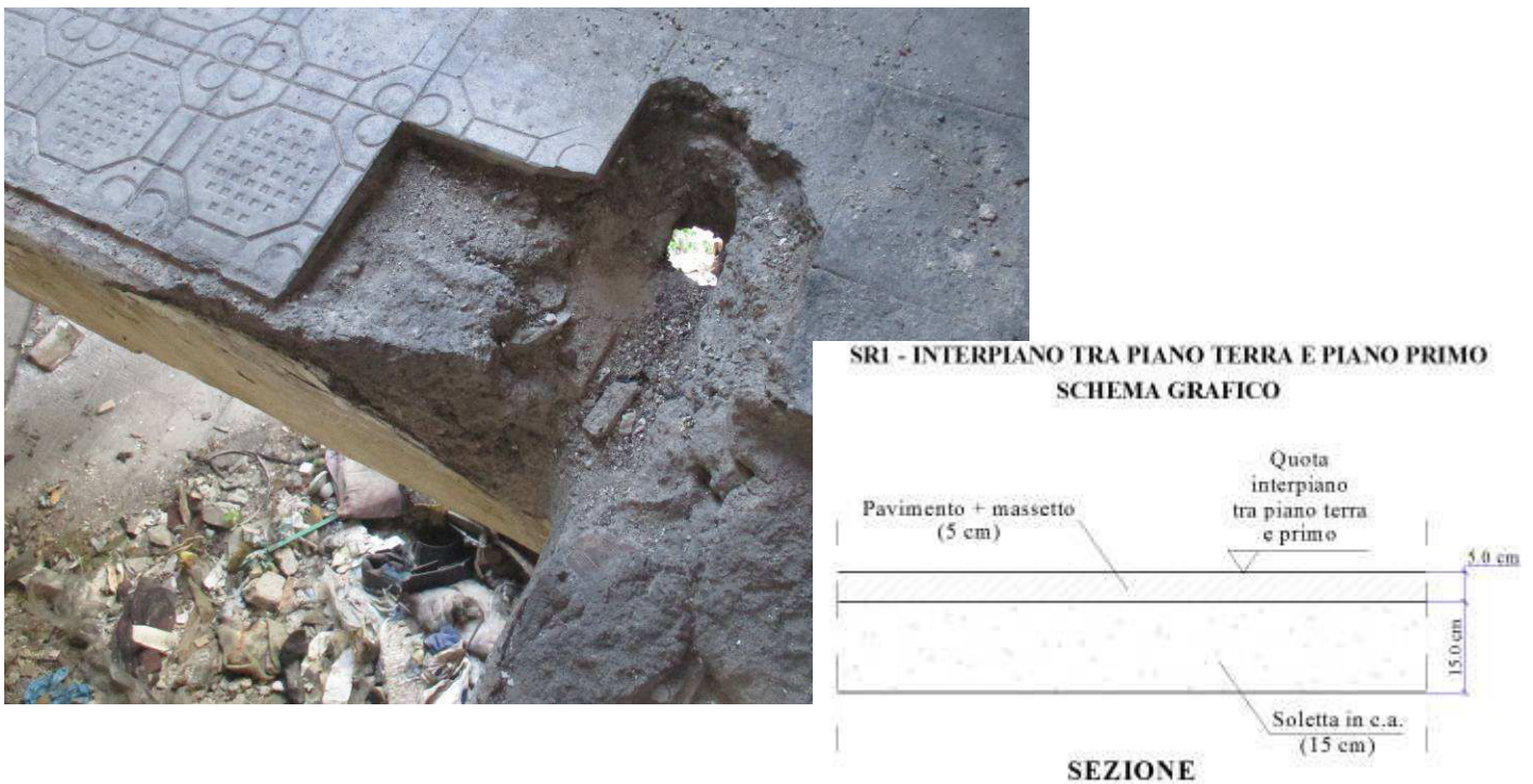
Foto 6 Indagine SR1 (saggio sulla scala) del Blocco A: è stata rilevata una soletta in c.a di spessore pari a 15 cm.
