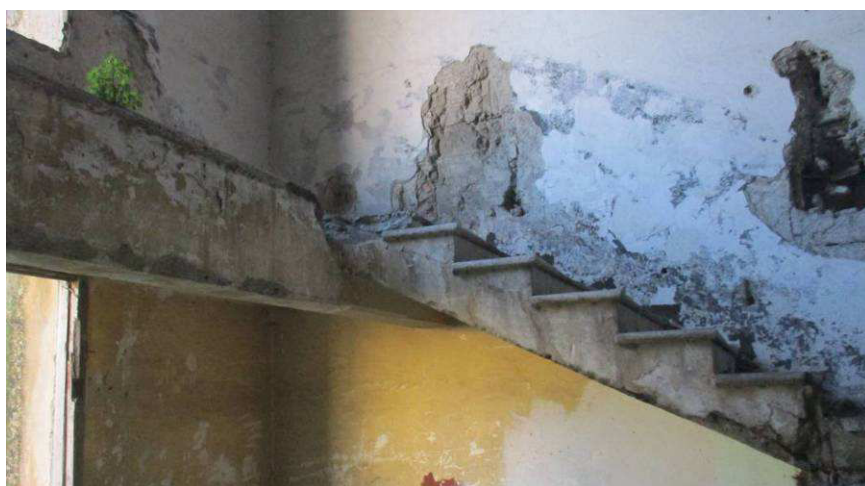
Foto 3 Vista della scala al piano terra del Blocco A: sono visibili le lesioni alle strutture delle scale
