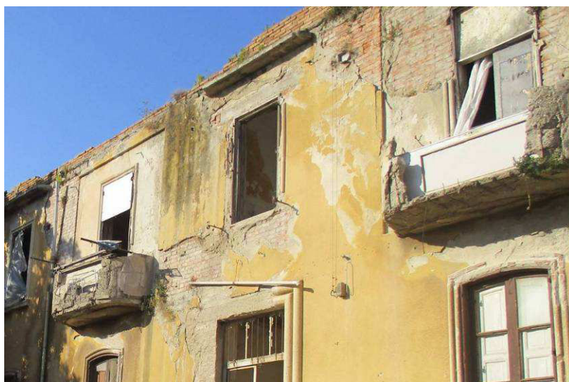
Foto 17 Vista della facciata sud-ovest del Blocco C: è visibile un crollo parziale dei parapetti dei balconi
