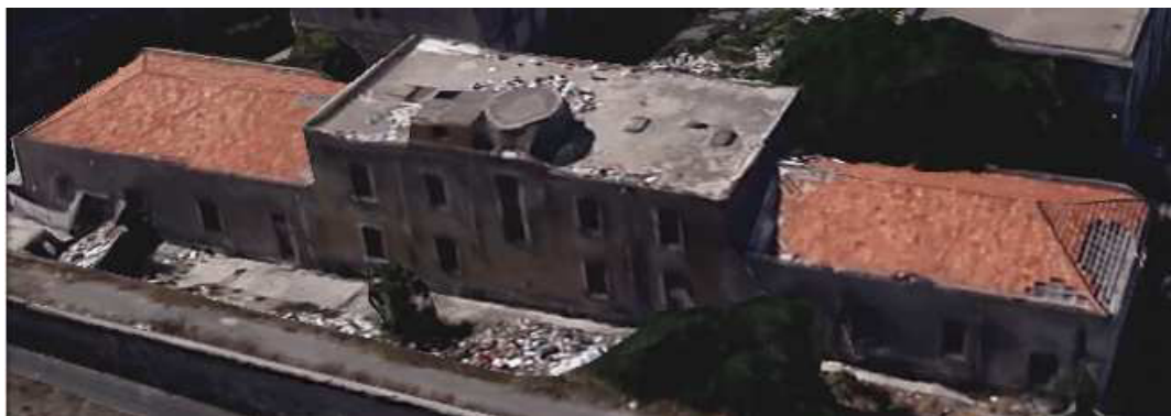
Foto 16 Vista aerea del Blocco C: è visibile un parziale distacco del manto di copertura
