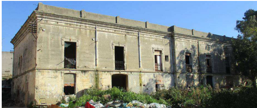
Foto 8 Vista della facciata nord-ovest del blocco B verso il cortile interno: sono visibili le condizioni di ammaloramento delle pareti esterne sia a piano terra che a primo piano.
