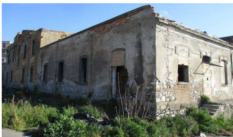
Foto 15 Vista della facciata nord-est del Blocco C: è visibile la caduta parapetto in mattoni pieni in copertura
