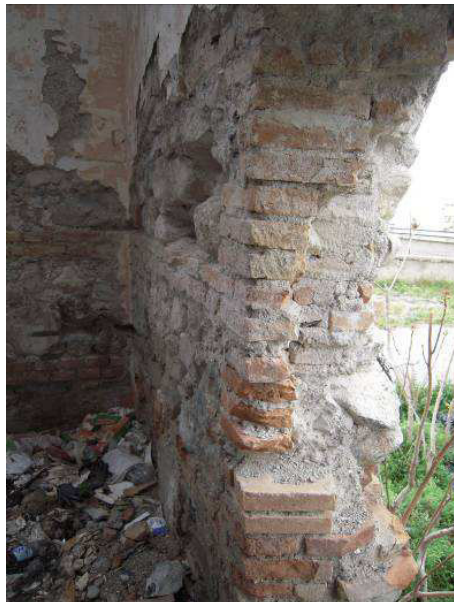
Foto 20 Indagine SP1 (saggio muratura) a piano terra del Blocco C: è visibile lo stato di degrado della muratura e il rilevante deterioramento malta
