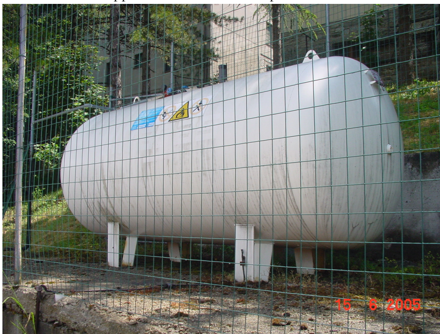
Figura 11 – Serbatoio GPL lato ovest
