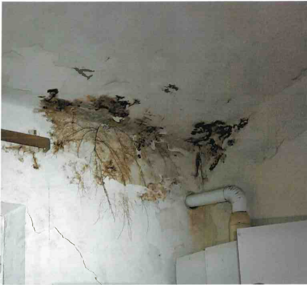
Fig. 28 – Radici degli arbusti cresciuti sulla copertura penetrati nel locale sottostante
