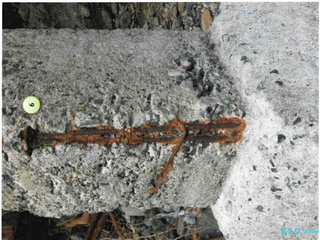
Fig. 22 – Ferri affioranti nel pilastro n° 6
