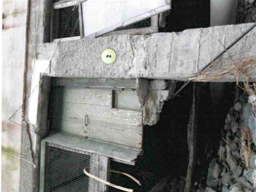
Fig. 23 – Porta di accesso ai locali sottostrada in adiacenza al pilastro n° 2 la cui soglia indica come in origine il terreno fosse ad una quota maggiore di quella attuale
