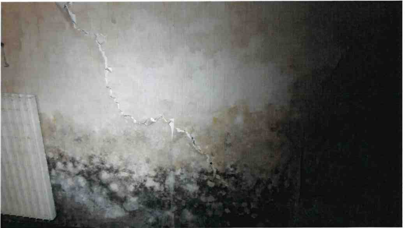
Fig. 30 – Ampie fessurazioni e muffe nelle murature
