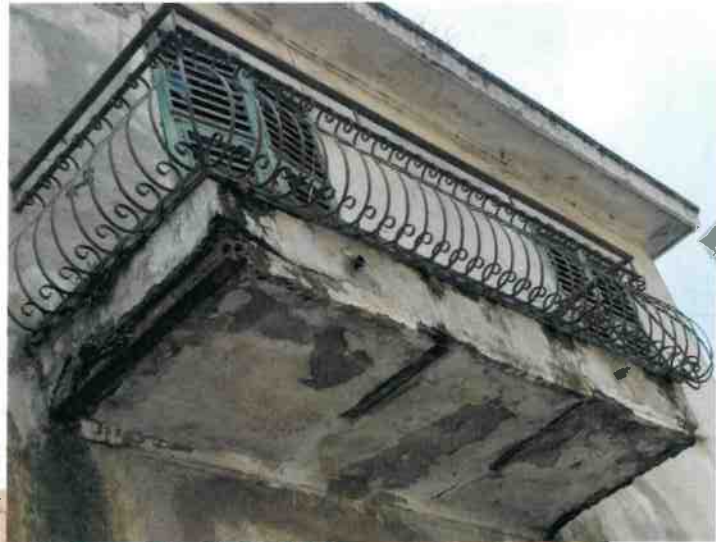
Fig. 26 – Struttura portante dei balconi non più protetta e ossidata
