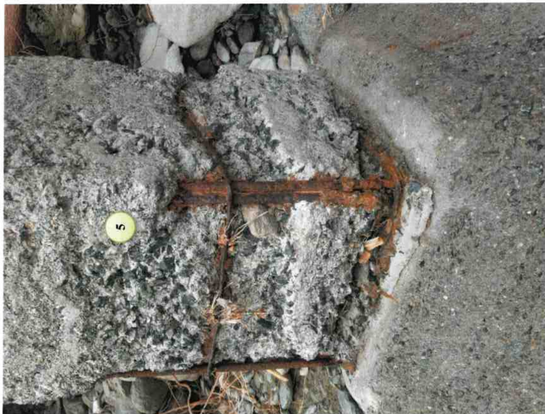
Fig. 21 – Ferri affioranti nel pilastro n° 5
