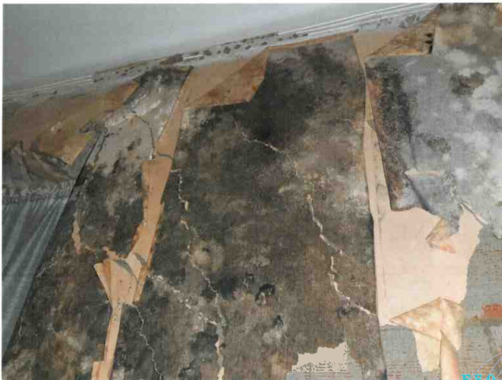
Fig. 29 – Ampie fessurazioni nelle murature
