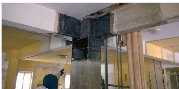
Figura 40 Esempi rinforzo nodi
