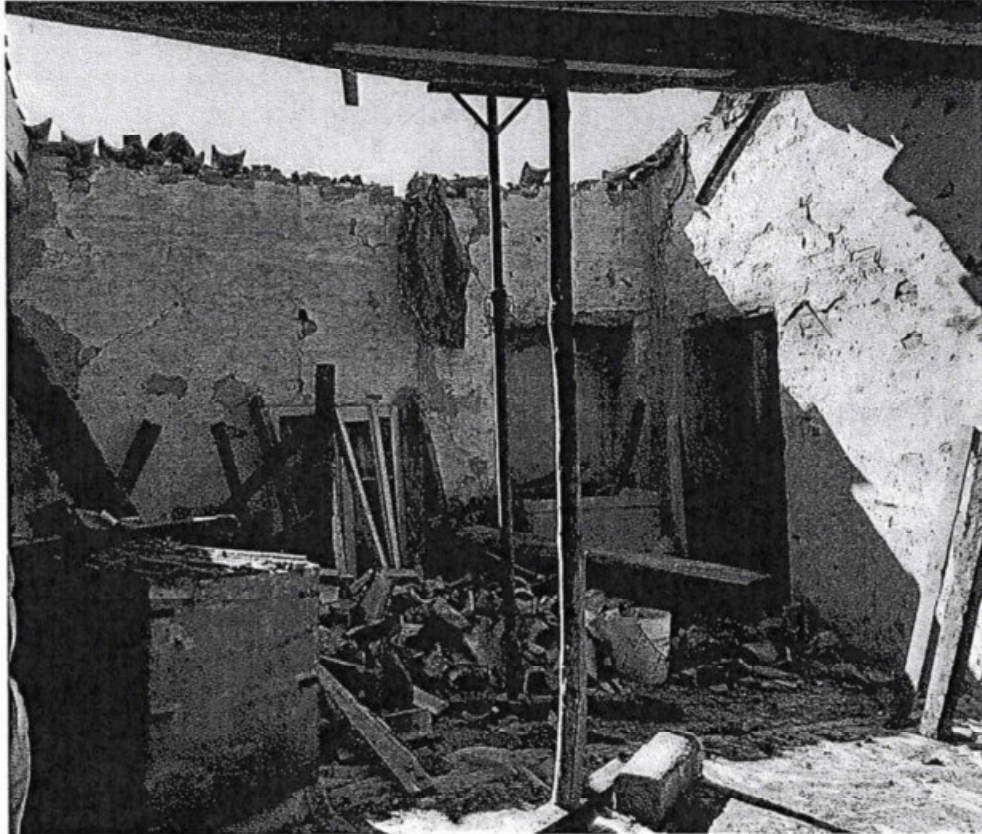
Foto 3. Vista sul materiale di risulta prodotti dal crollo
