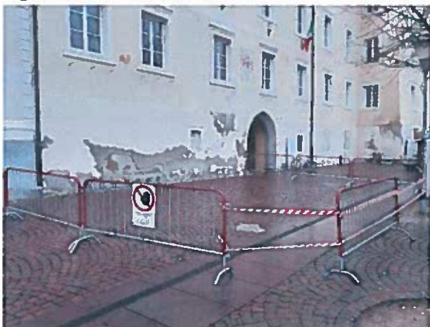
Foto 3: Vista sull'area a rischio di caduta di tegole
