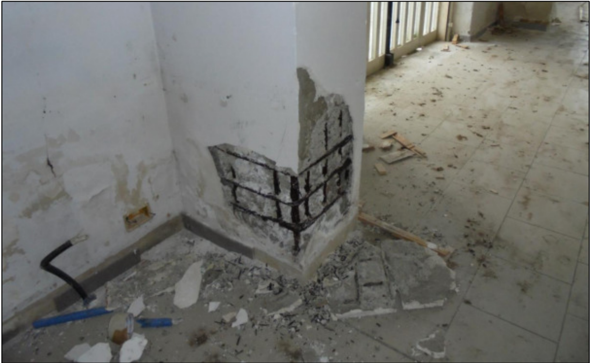
Figura 13 - Distacco copriferro pilastri in cls
