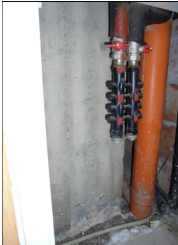
Figura 11 - Collettore impianto riscaldamento
