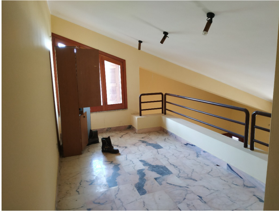
Figura 4, Esempio di impianto elettrico spostato rispetto le travi portanti.
