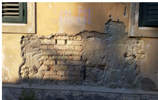
Fig. 2 - Tipologia muraria. Muratura in mattoni pieni confinati tra strutture verticali in c.a.
