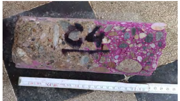
Profondità di carbonatazione
