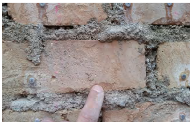
Fig. 4 - Lesione registrata in corrispondenza di un elemento murario.
