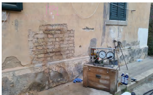
Fig. 1 - Postazione di prova.
