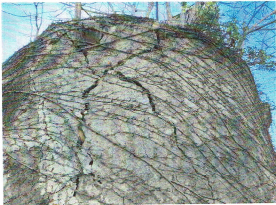
Fig. 5 – Particolare delle porzioni di muratura perimetrale sul fronte Nord in fase di completo distacco
