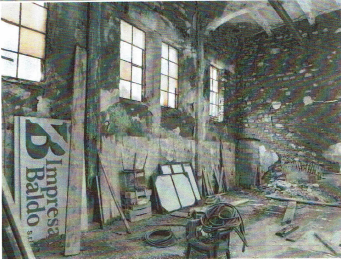
Fig. 14 – Vista interna del muro perimetrale a Nord-Est del corpo D con finestra da tamponare
