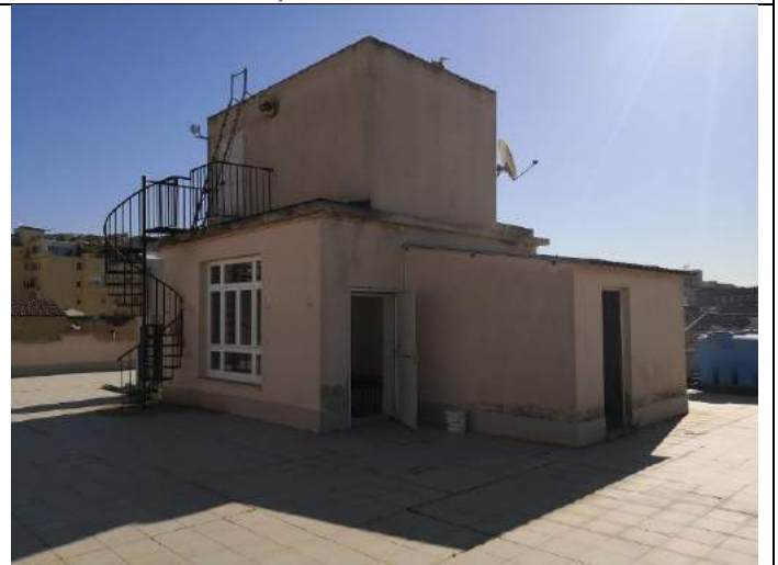
Vani tecnici in copertura
