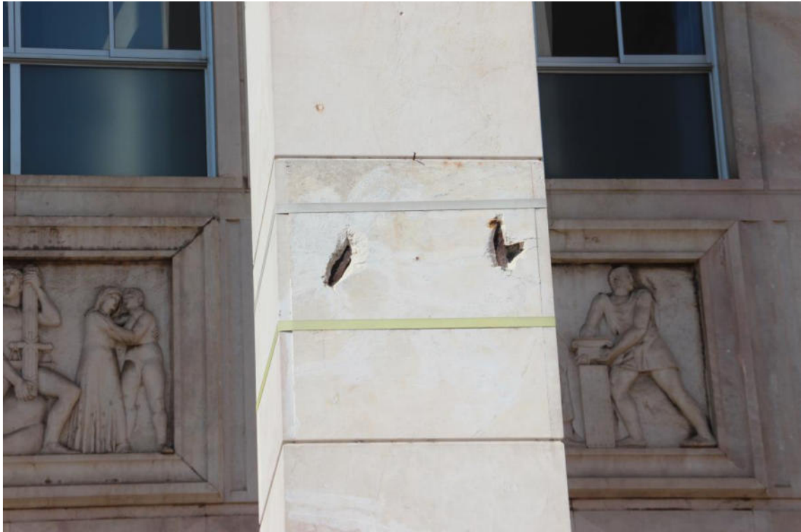
Fig. 20. Degrado di una lastra di rivestimento dei pilastri a causa dell'ossidazione dei ferri sottostanti
