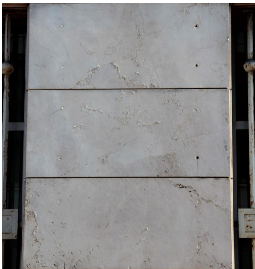
Fig. 22. Degrado superficiale delle lastre in marmo di Zandobbio
