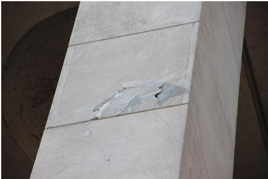
Fig. 21. Degrado di una lastra di rivestimento dei pilastri con distacchi e fessurazione
