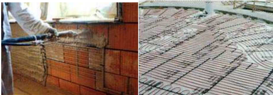
Pannelli radianti a parete e a pavimento
