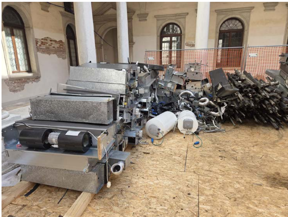
Foto D.1 – Chiostro: ventilconvettori smontati con motori, batterie di scambio e collegamenti elettrici residui; a destra, tubazioni coibentate e condotti flessibili.
