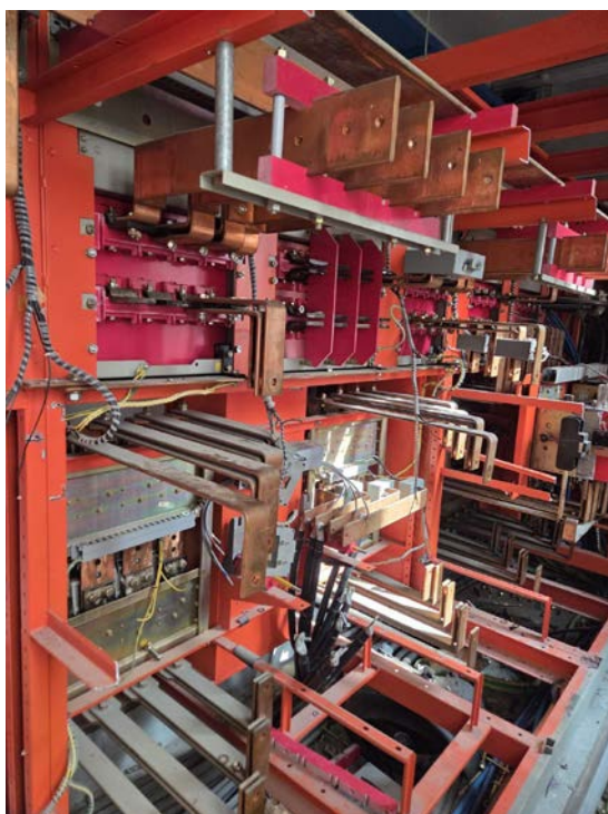
Foto A.3 – Quadro elettrico generale: vista d'insieme delle sbarre e delle connessioni in rame.
