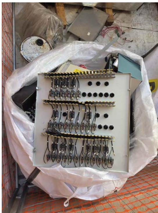
Foto E.3 – Pannello di quadro di comando con apparecchiature e cablaggi, raccolto in saccone con altre apparecchiature elettriche.
