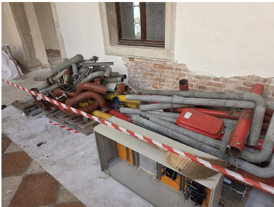
Foto C.2 – Portico del chiostro: tubazioni idrauliche in acciaio, curve, valvole flangiate e vaso di espansione.
