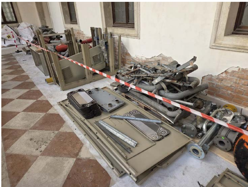
Foto E.2 – Portico del chiostro: carpenterie di quadri e armadi smontati, piastre di scambiatore di calore, tubazioni e valvole flangiate.
