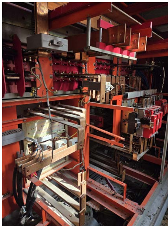
Foto A.2 – Quadro elettrico generale: sbarre principali e derivazioni in rame ancora in opera.
