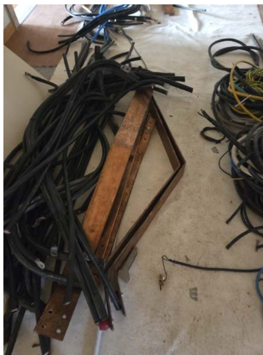
Foto A.4 – Sbarre e connessioni in rame smontate, frammiste a cavi di potenza da separare (lotto B).
