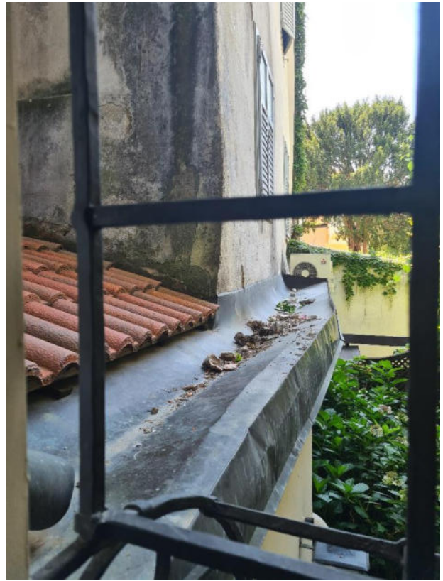
Foto 2: Vista su materiale caduto dal cornicione
