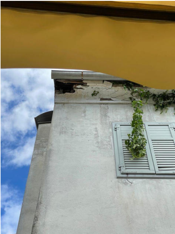
Foto 1: Vista sul cornicione pericolante
