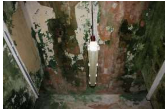
Patologie di degrado
