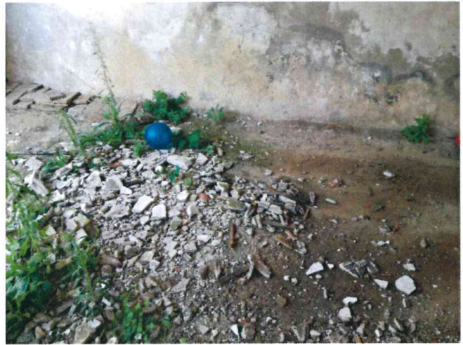
Fig. 5 Parti di controsoffitto crollato
