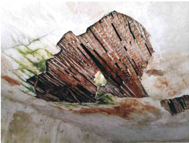
Fig. 4 Controsoffitto crollato in corrispondenza del sottoportico
