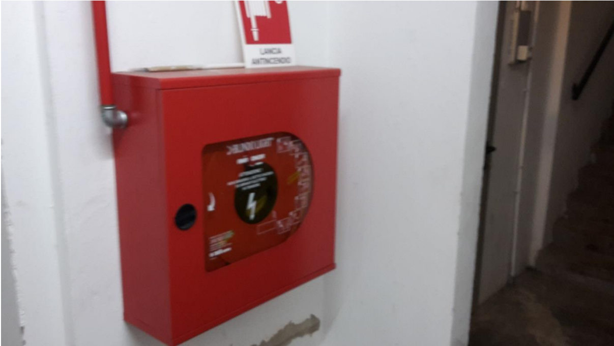
Impianto antincendio (piano interrato).
