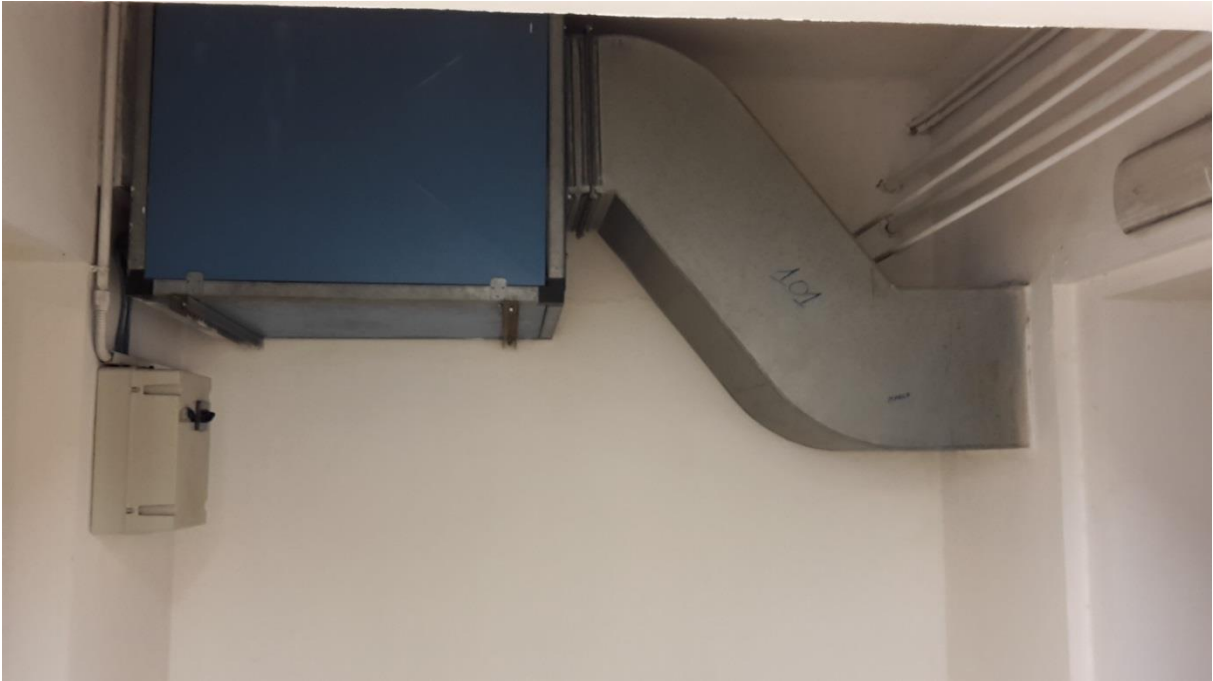
Unità di trattamento aria (piano interrato).
