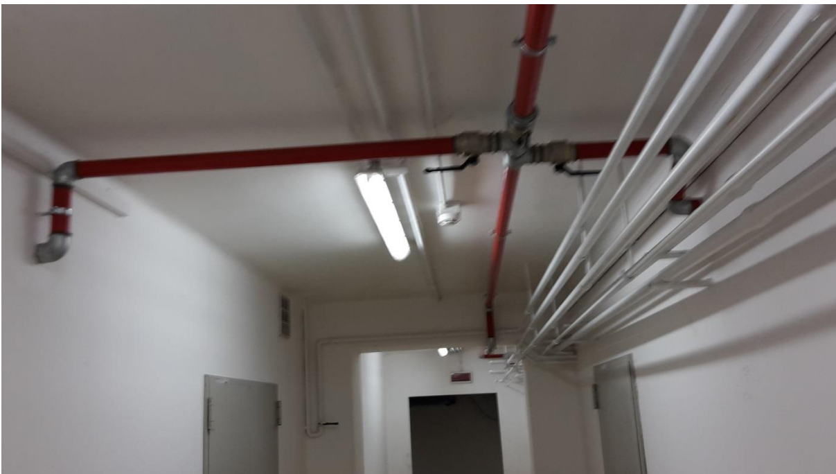
Rete idrica antincendio e rilevatori di fumo (piano interrato).
