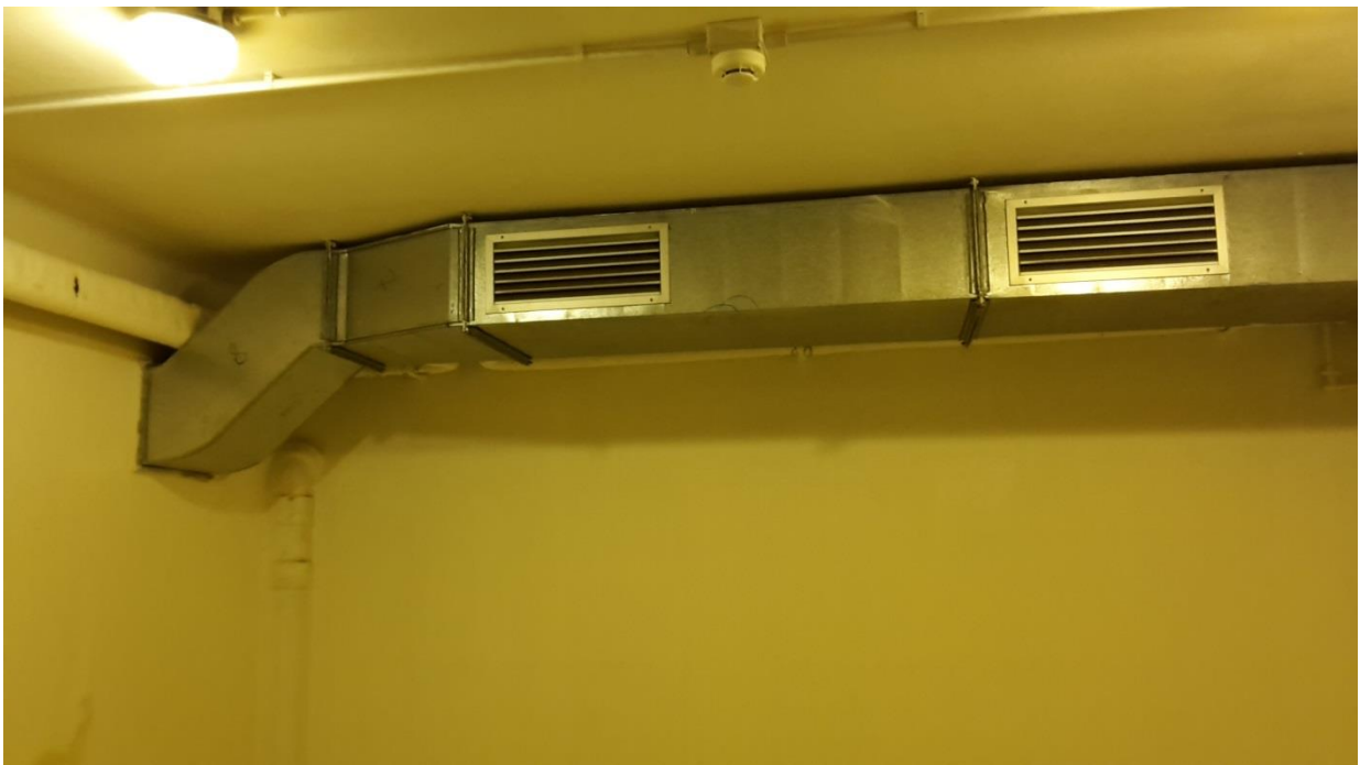
Condotto dell'impianto di trattamento aria (piano interrato).
