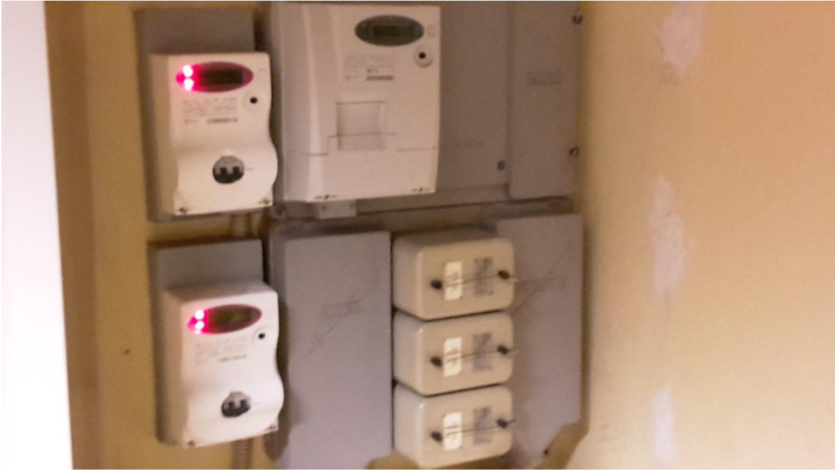
Contatore elettrico (piano terra – lato via Sant'Isaia).
