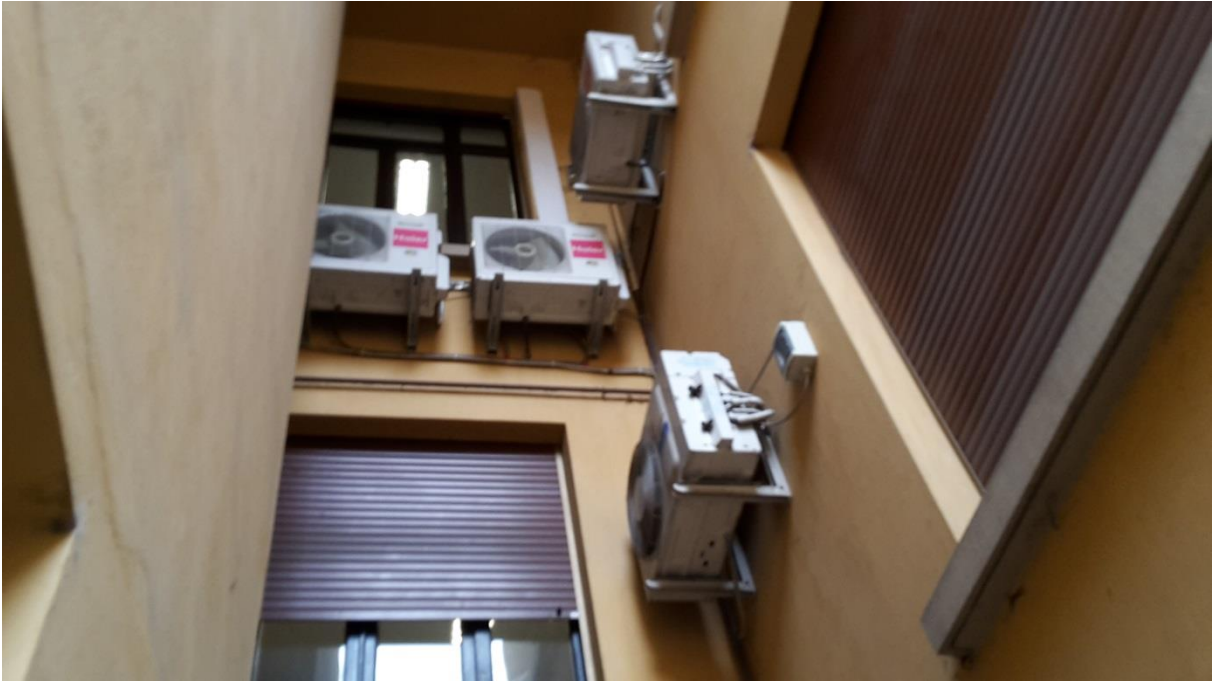
Condizionatori d'aria posti su lato rivolto sul chiostro condominiale (sub 33).
