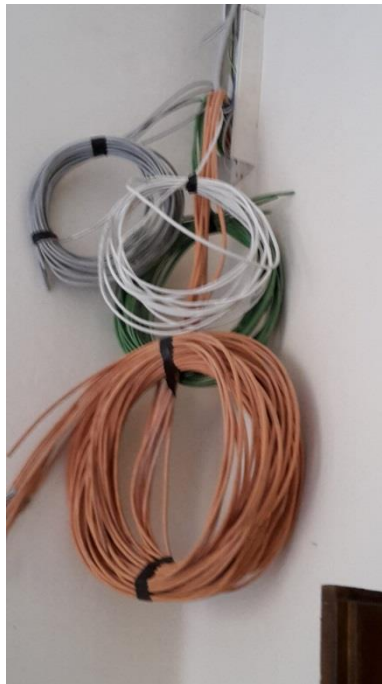
Cablaggio passivo dati attualmente sconnesse dall'armadio rack (assente)
