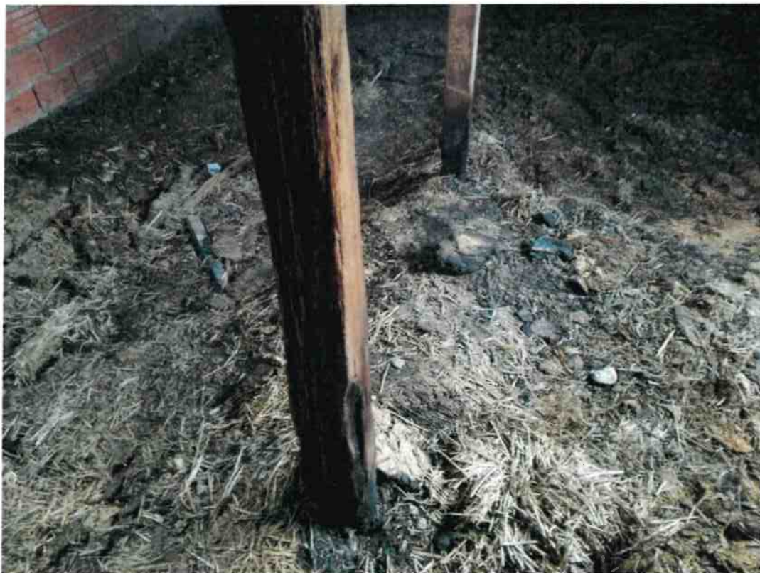
Fig. 17 – Interno corpi di fabbrica C1 visto da Nord Particolare stato attuale colonne in legno dopo l'incendio
