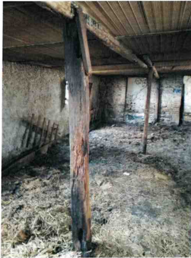
Fig. 16 – Interno corpi di fabbrica C1 visto da Sud Particolare stato attuale colonne in legno dopo l'incendio
