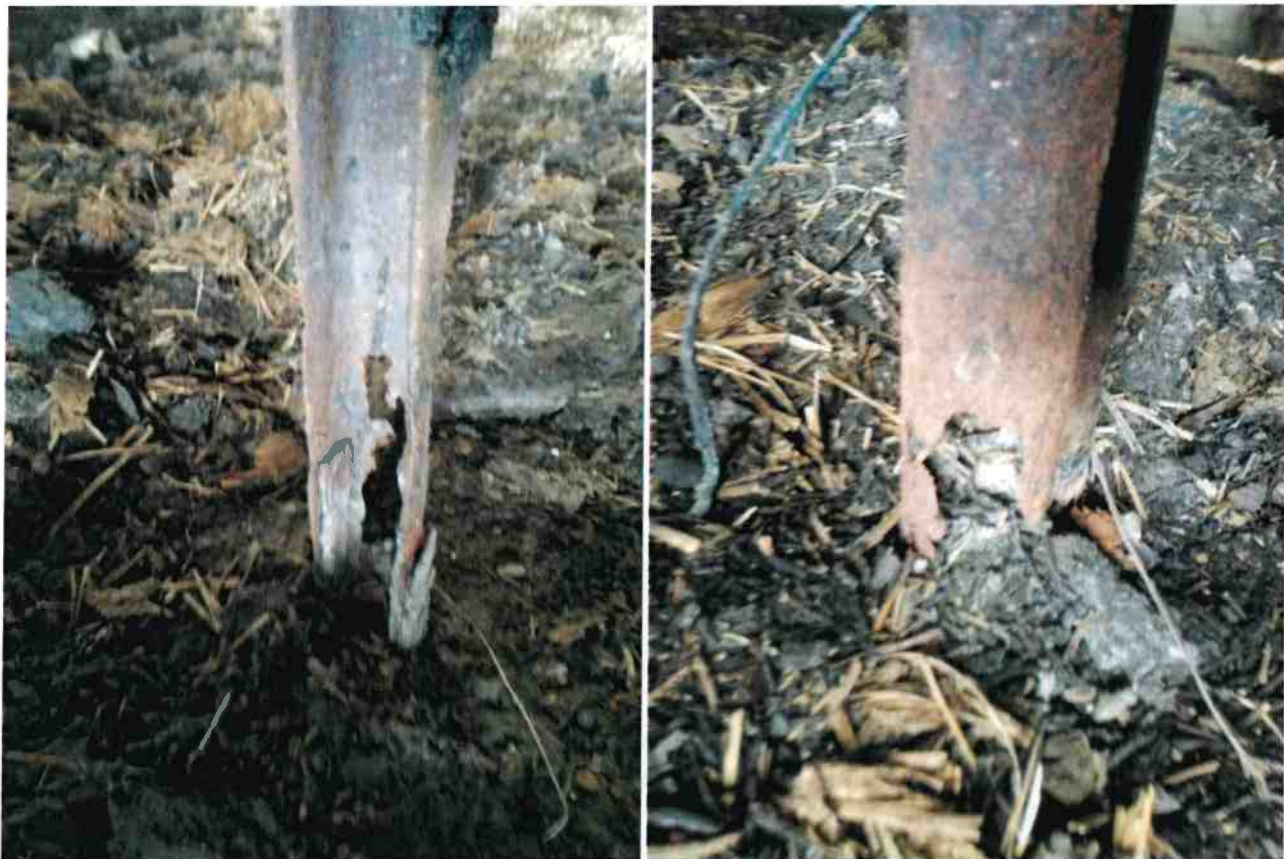
Fig. 20 – Interno corpi di fabbrica C2 – Stato attuale piede colonne in ferro
