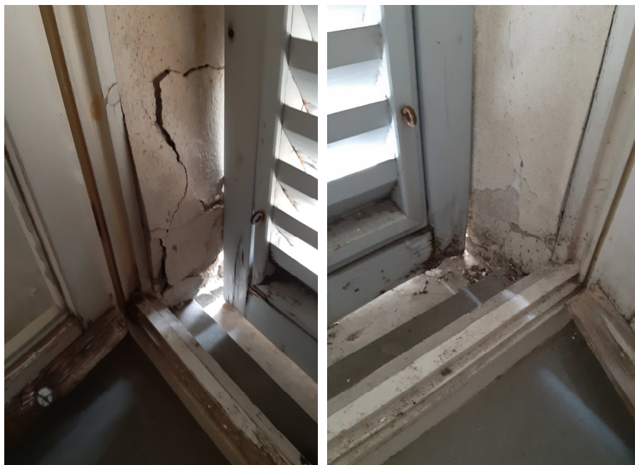
Foto 3: la finestra di Dx. In evidenza il distacco delle spallette dell'imbotte e le condizioni di marcescenza della persiana.
