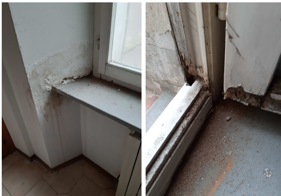
Foto 2: Dettagli dell'infisso di sinistra. In evidenza il pesante ammaloramento delle spallette in prossimità dell'inserimento della soglia e le condizioni di marcescenza delle ante e del telaio.
