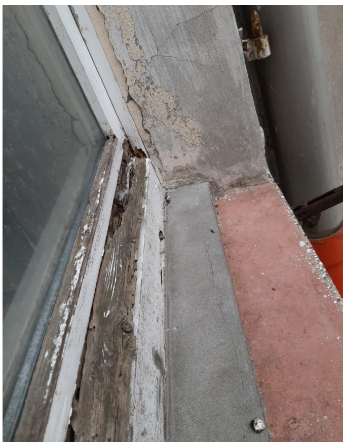
Foto 3: Dettaglio delle soglie della finestra di Sx: di colore rosa la soglia originale in cotto, in grigio quella di più recente posa in pietra serena grigia. Si evidenzia anche la crepatura di quest'ultima a causa dell'imbibizione a cui il materiale è soggetto. Evidente anche lo stato di marcescenza dell'infisso.
