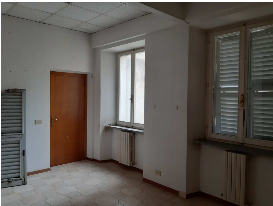
Foto 1: Stanza n.12: le due finestre in condizioni critiche.
