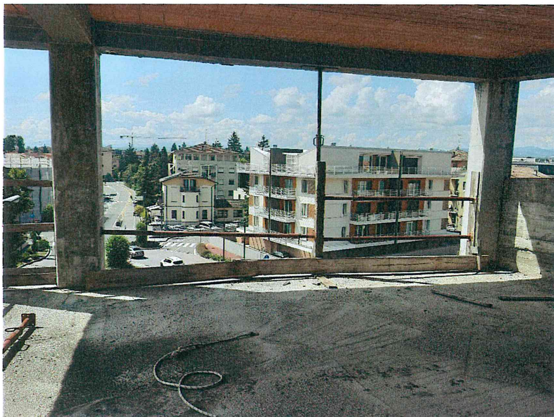
Fig.6: Parapetti piano quarto oggetto di cedimento
