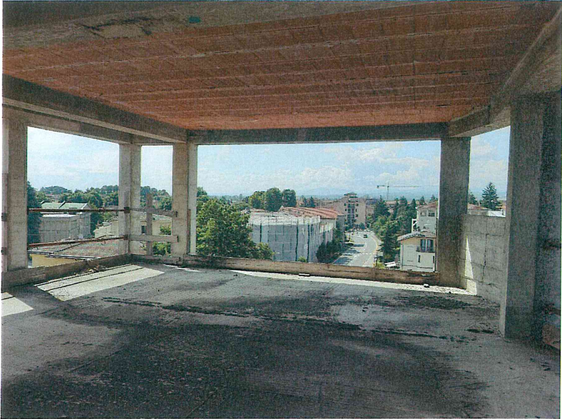
Fig.7: Parapetti piano quinto – si noti la totale mancanza dei parapetti caduti
