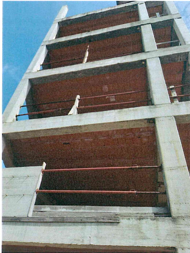
Fig.4: Prospetto oggetto di caduta elementi provvisionali
