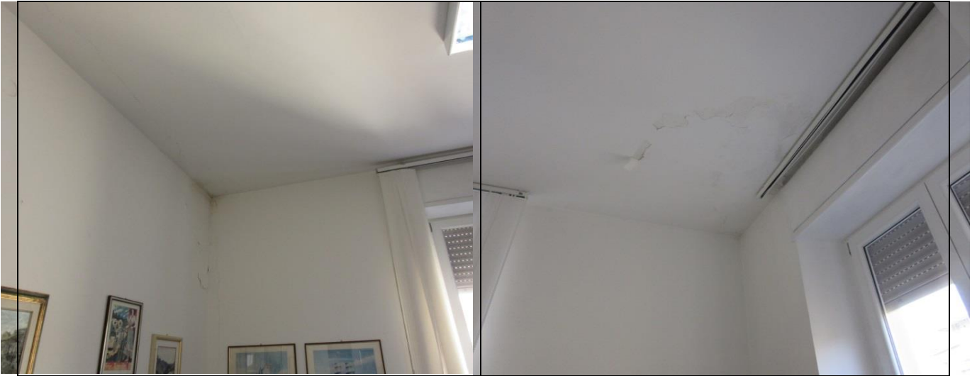
Danneggiamenti interni piano terzo, fabbricato 3 - CAB0551-FIP, Via Lo Frasso n.4.
