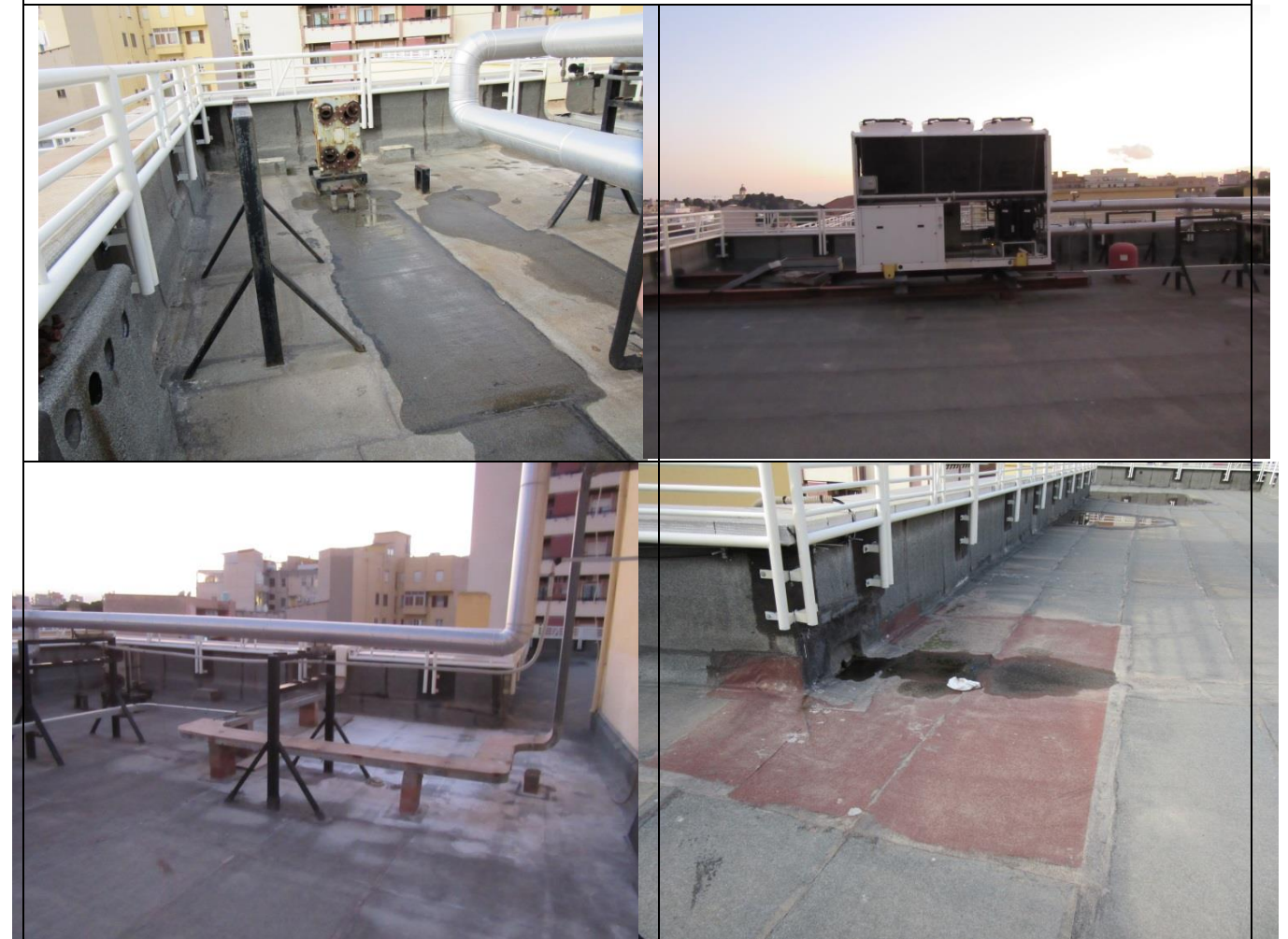
Danneggiamenti copertura fabbricato 3 - CAB0551-FIP, Via Lo Frasso n.4.
