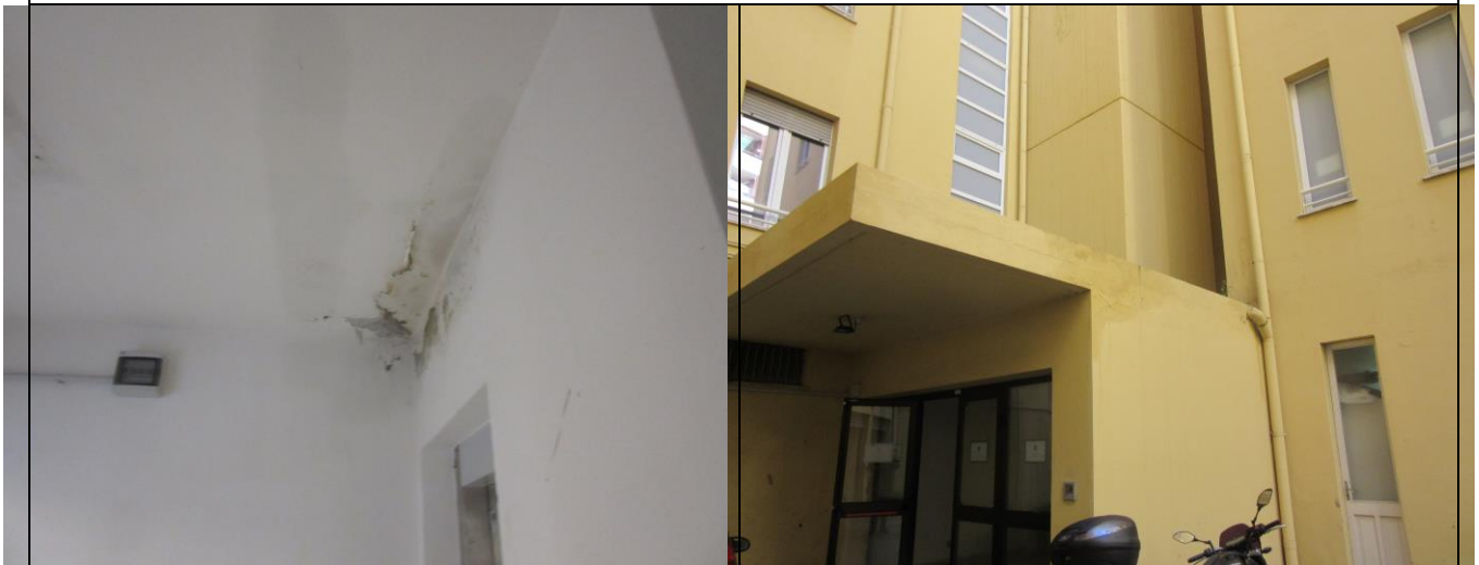
Atrio ascensore - infiltrazioni acqua piovana ed accesso dal cortile interno carrabile. Fabbricato 3
