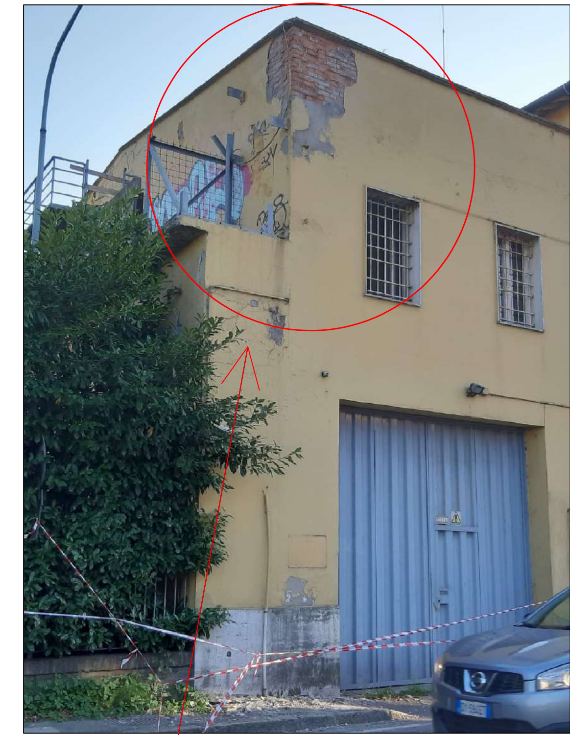
Intervento in somma urgenza del Comando Provinciale dei Vigili del Fuoco di Modena con rimozione delle porzioni di intonaco staccate - l'intervento si è reso necessario a seguito di caduta di intonaco su strada Panni - Modena
