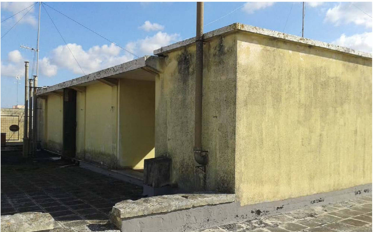
Foto 22 - Piano di copertura – Particolare deposito e torrino scala con pensilina di collegamento
