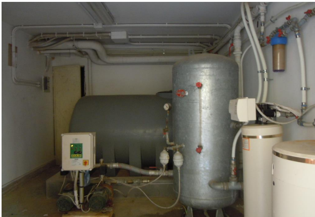
Foto 10 - Piano semiinterrato – particolare centrale idrica ed accesso all'intercapedine interna
