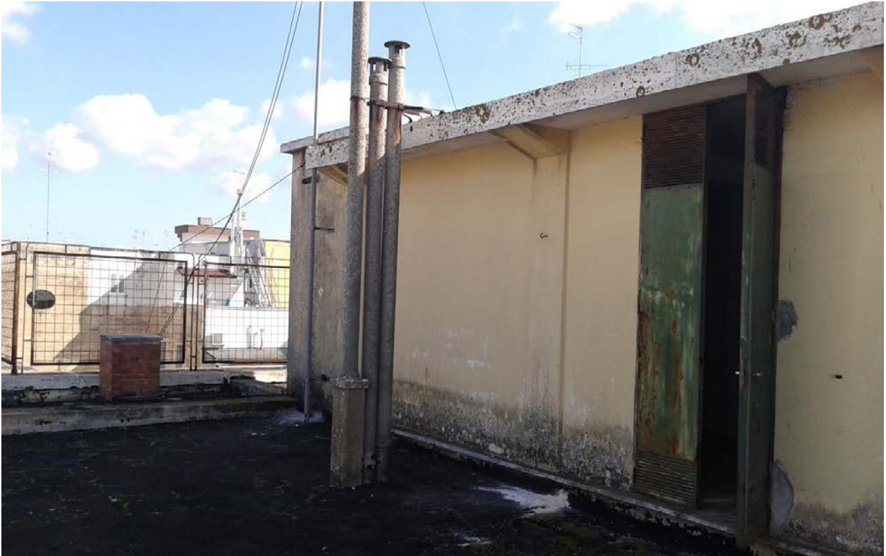
Foto 21 - Piano di Copertura – Particolare deposito con elementi in cemento amianto
