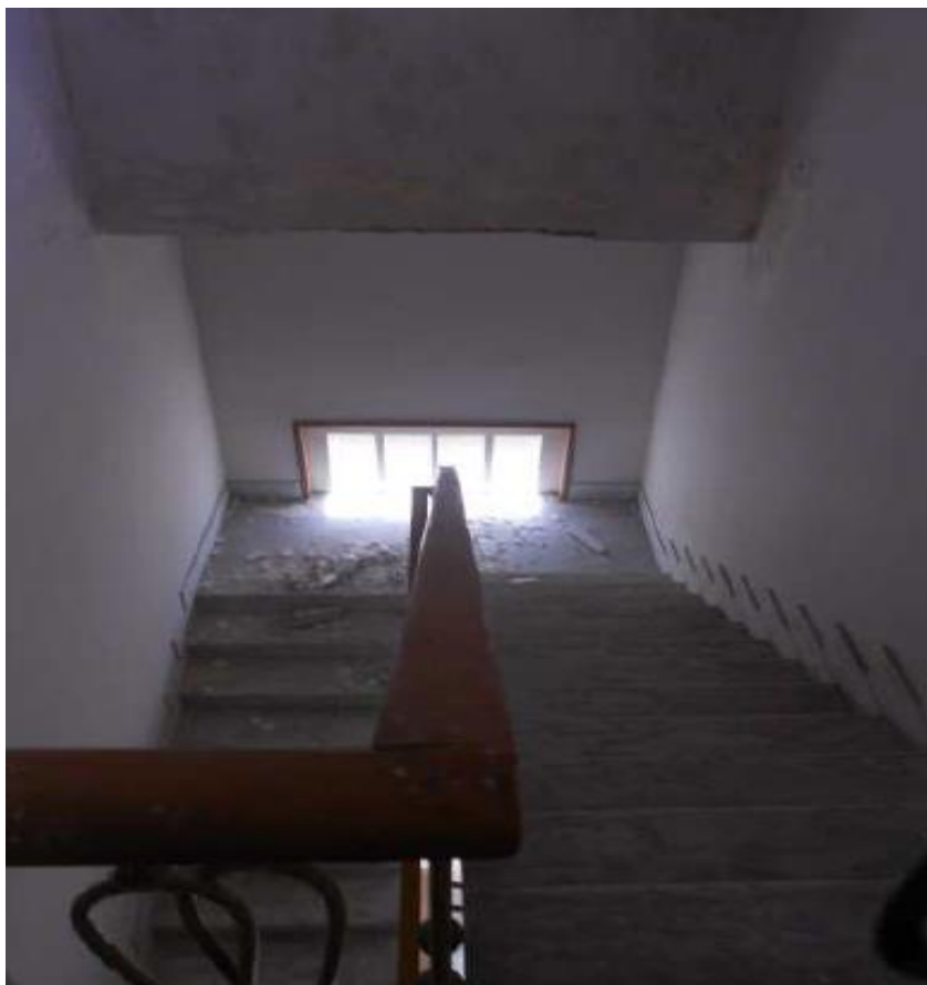
Foto 28 - Scala secondaria – particolare solaio di copertura degradato
