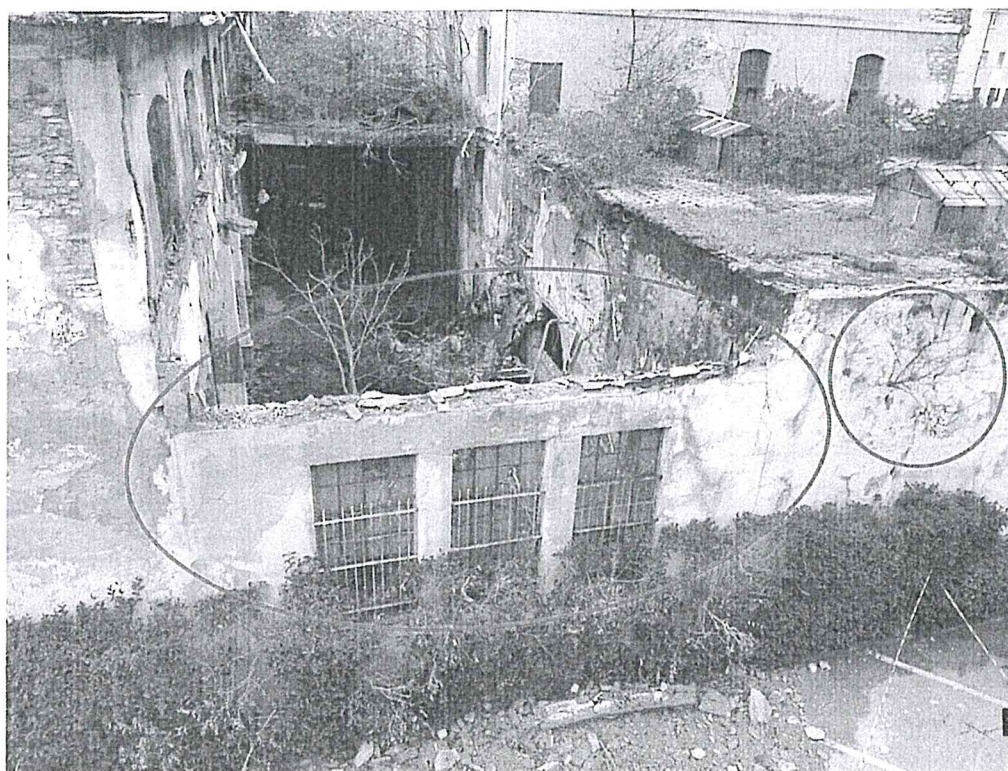
Fig. 8 – Crollo di porzione della muratura perimetrale sul fronte a Sud-Est ed evidenziazione dell'arbusto cresciuto sulla muratura perimetrale da tagliare, nonché delle residua porzione di muratura perimetrale da consolidare
