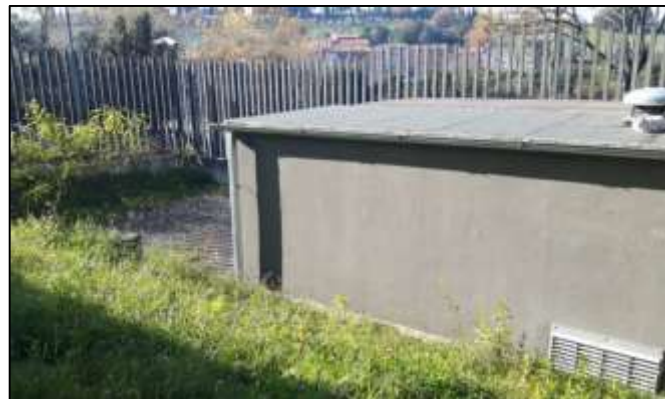
Foto 8: Cabina elettrica (su p.lla 5200)
