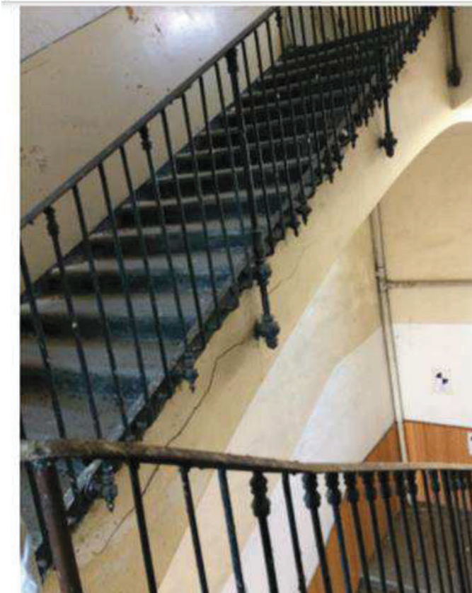
Stato attuale parapetto
