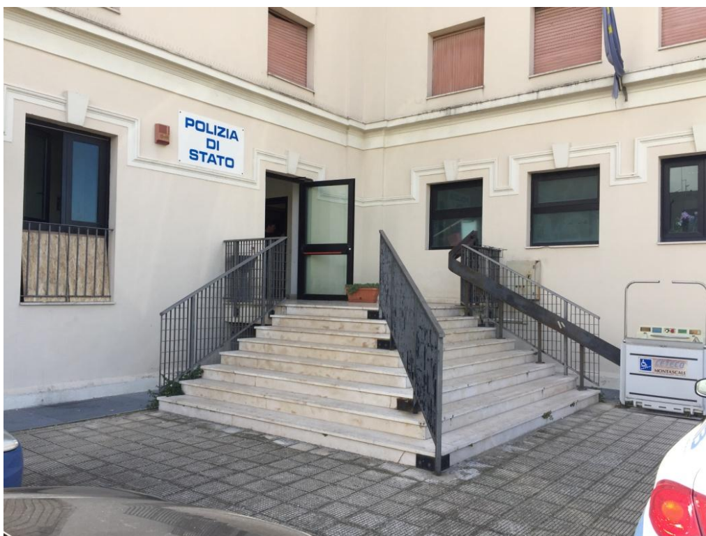
Foto: accesso allo stabile mediante rampa di scale non presente negli elaborati progettuali
