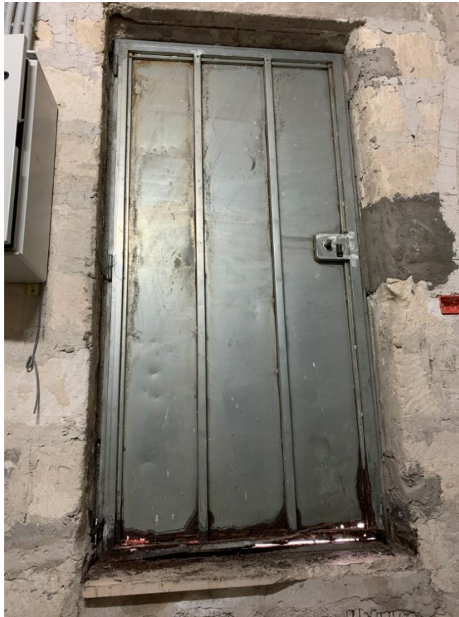
Foto: porta di accesso al lastrico solare bloccata
