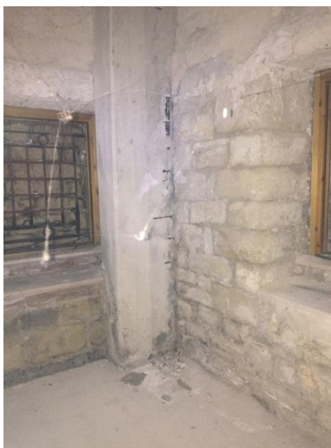
Fenomeni di degrado nel Pilastro 3 a piano interrato.
