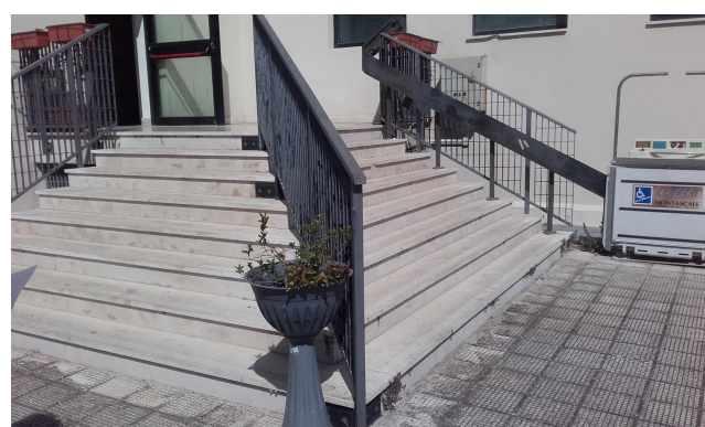
Particolare scala ingresso con servoscala
