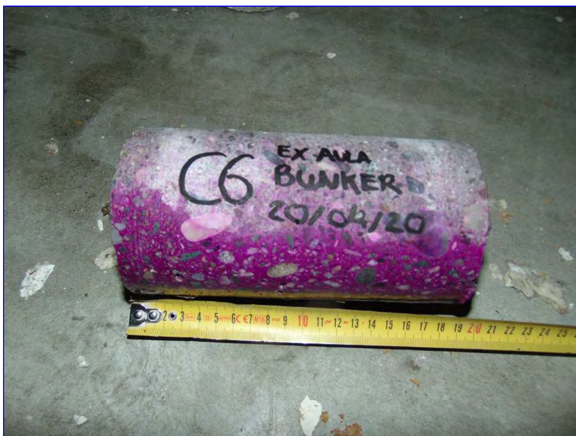
Campione C 6 – profondità di carbonatazione 0 cm.
