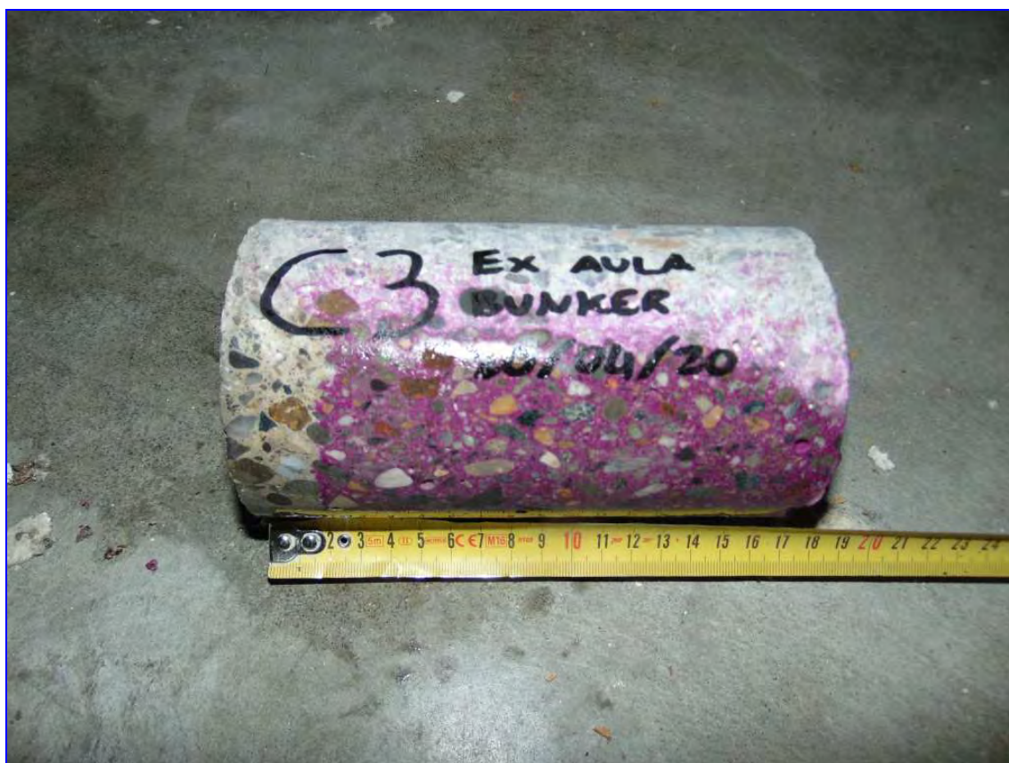
Campione C 3 – profondità di carbonatazione 2,5 cm.
