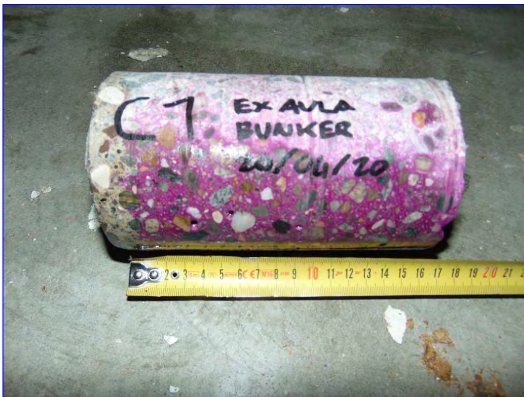
Campione C 1 – profondità di carbonatazione 1,5 cm.
