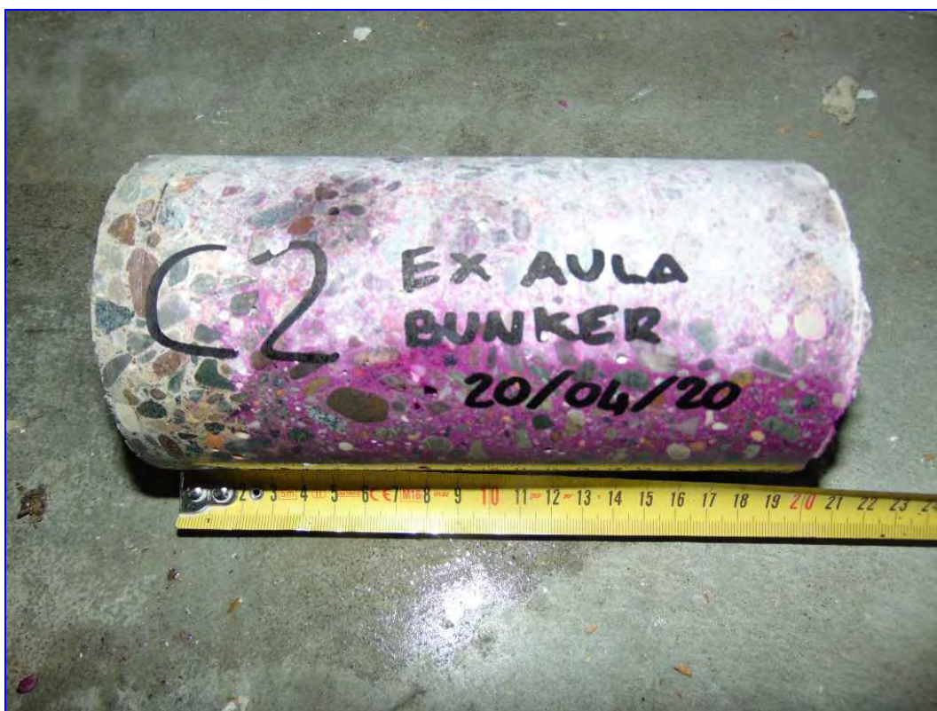
Campione C 2 – profondità di carbonatazione 3 cm.
